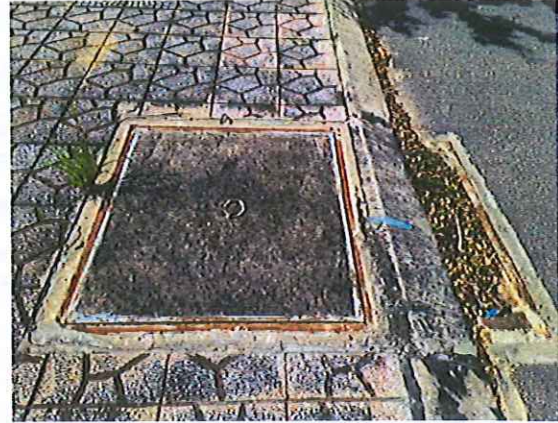
Hình 3. 2. Hố ga thu gom nước mưa
