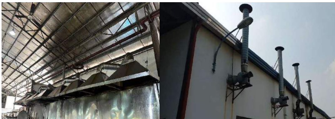
Hình 3.10. Thu gom mùi, hơi nóng của nhà bếp
