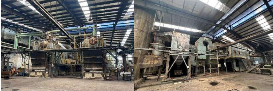
Hình 3.9. Khu vực lò hơi, lò dầu và hệ thống xử lý khí thải lò hơi
