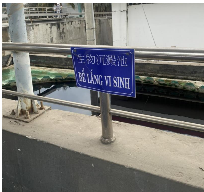
Hình 3. 5. Bể lắng vi sinh
