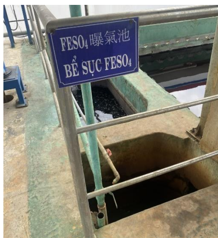
Hình 3. 6. Bể điều chỉnh pH 2 tại hệ thống xử lý
