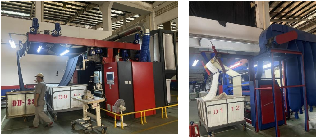
Hình 3. 9. Thiết bị lọc bụi túi vải tại nhà máy
