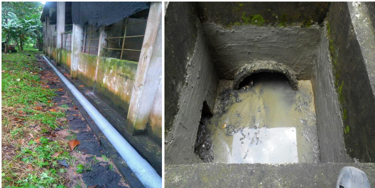
Hình 3. 1. Hình ảnh hệ thống thu gom nước thải
