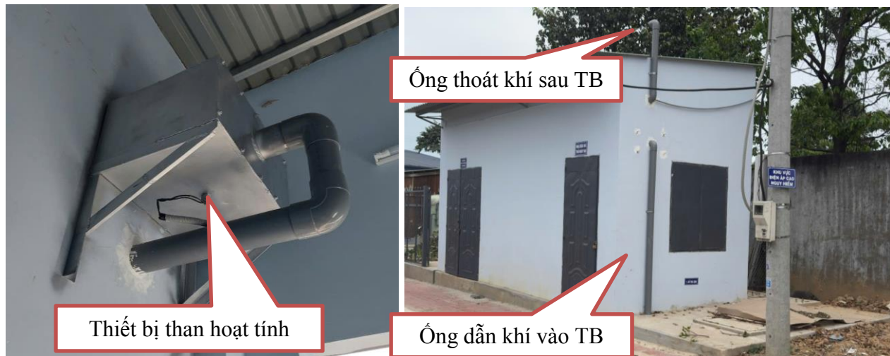
Hình 3. 5. Hình ảnh hệ thống xử lý mùi từ quá trình xử lý nước thải
