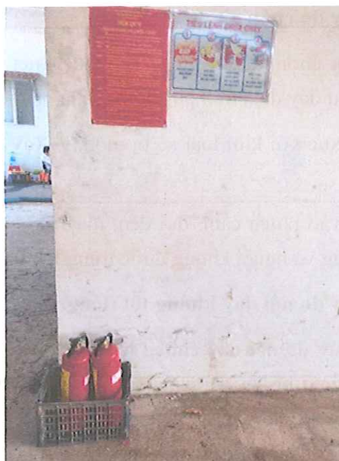
Hình 3. 7. Thiết bị phòng cháy chữa cháy
