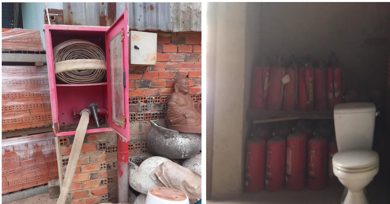
Hình 4. 15. Hình ảnh hệ thống PCCC thực tế tại công ty
