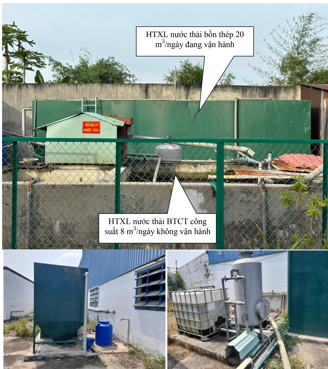
Hình 4. 5. Một số hình ảnh thực tế của hệ thống xử lý nước thải tại Công ty
