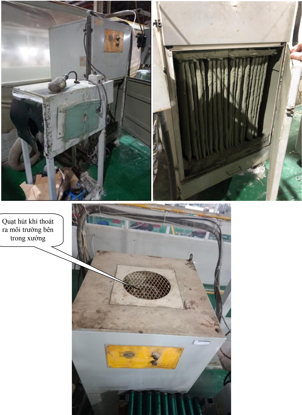
Hình 3. 6. Hình ảnh thiết bị xử lý bụi công đoạn chà đầu ống thủy tinh
