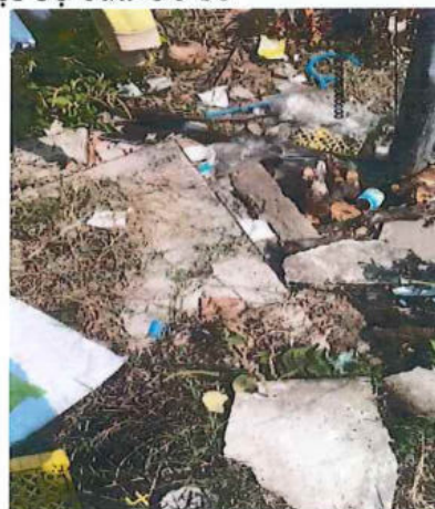
Hố ga đầu nối trên đường N1 tại vị trí số 1
