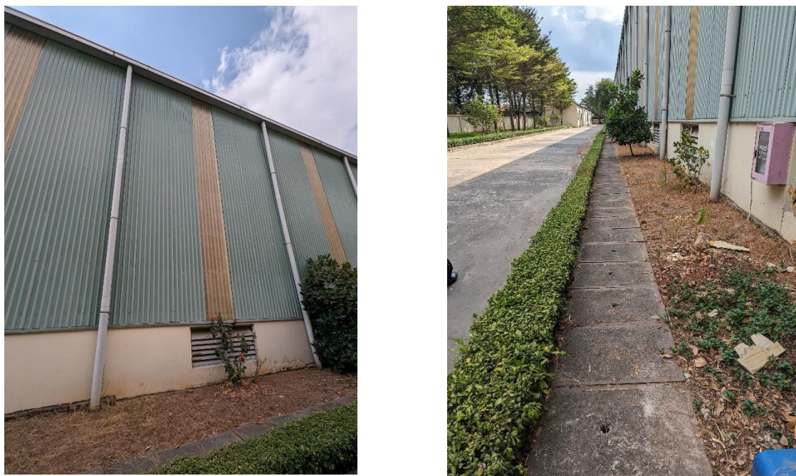
Hình 3. 2: Hình ảnh hệ thống thu gom, thoát nước mưa của cơ sở.
