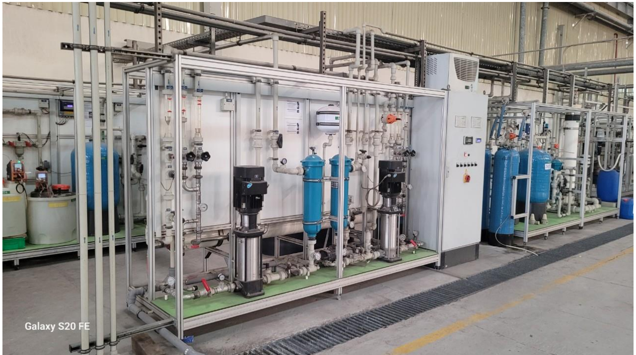
Hệ thống lọc nước RO phục vụ công đoạn rửa kính
