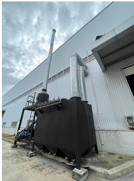
Hình 3.8. Hệ thống xử lý khí thải tại dây chuyền sản xuất sản phẩm dạng bột, dạng hạt và đóng gói dạng lỏng, dạng huyền phù, công suất 19.000 m 3 /h (Khu A)
