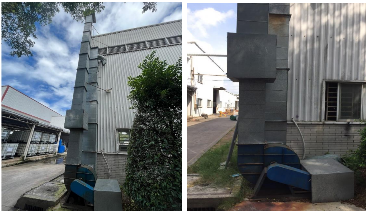
Hình 3.10. Hệ thống xử lý khí thải tại dây chuyền sản xuất sản phẩm dạng lỏng, dạng huyền phù, công suất 1.000 m 3 /h (Khu B)
