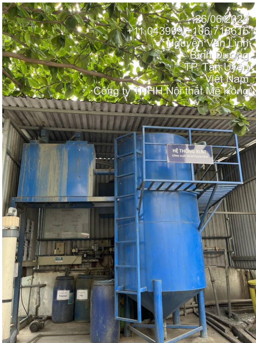
Hình 3.6 Hệ thống xử lý nước thải 80 m 3 /ngày.đêm tại cơ sở
