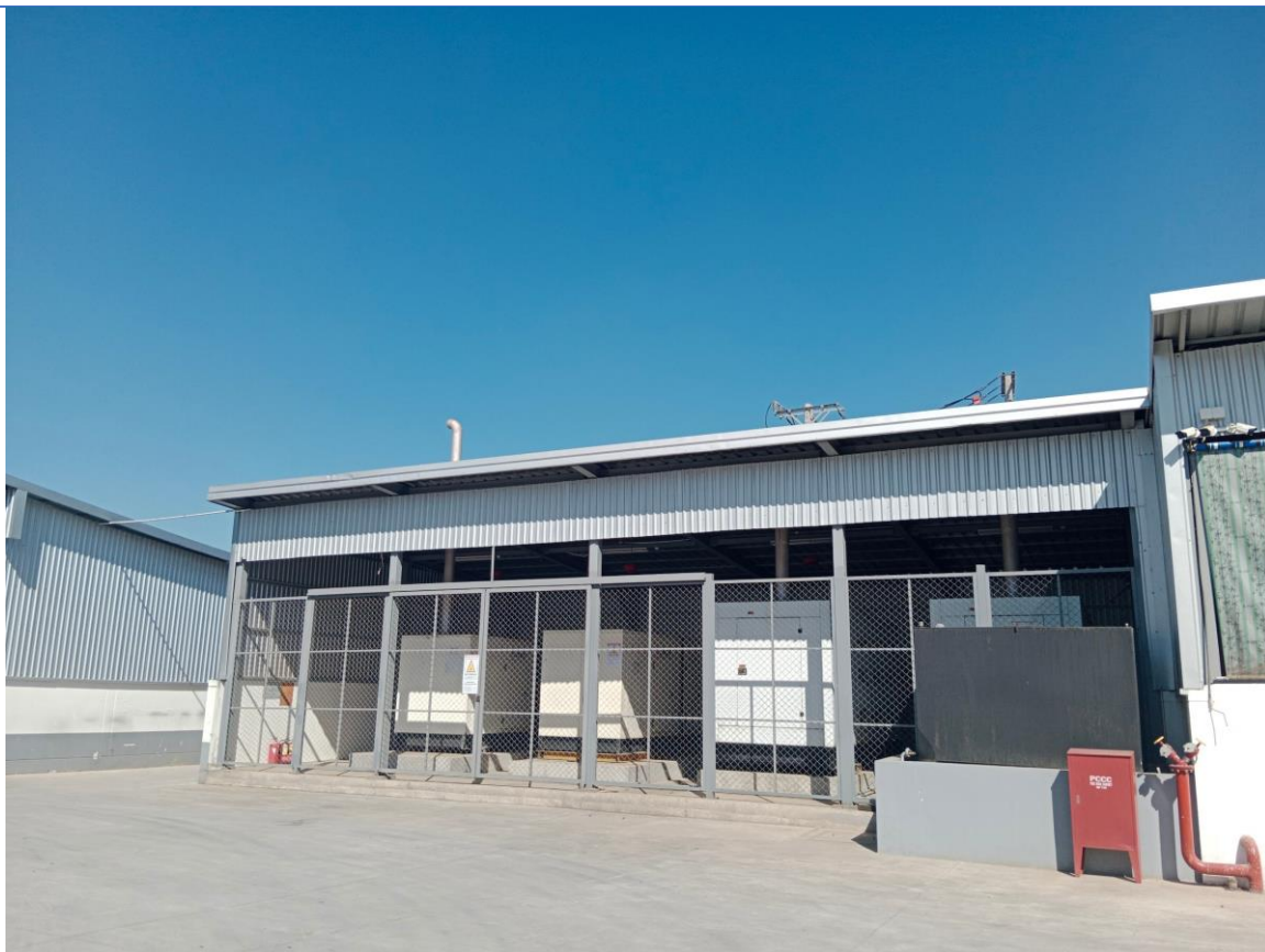
Hình 25. Khu vực máy phát điện
