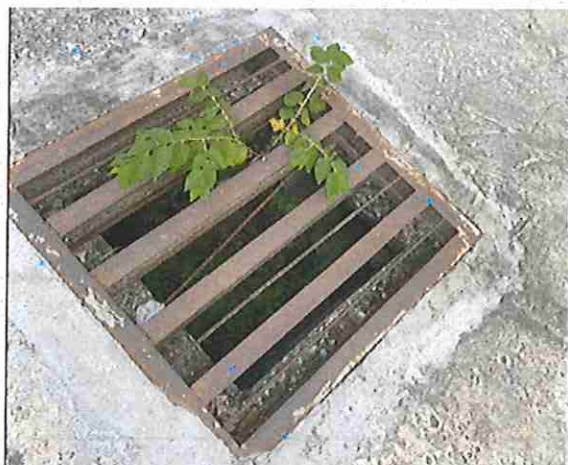
Hình 3. 2. Hố ga thoát nước mưa trong khuôn viên cơ sở
