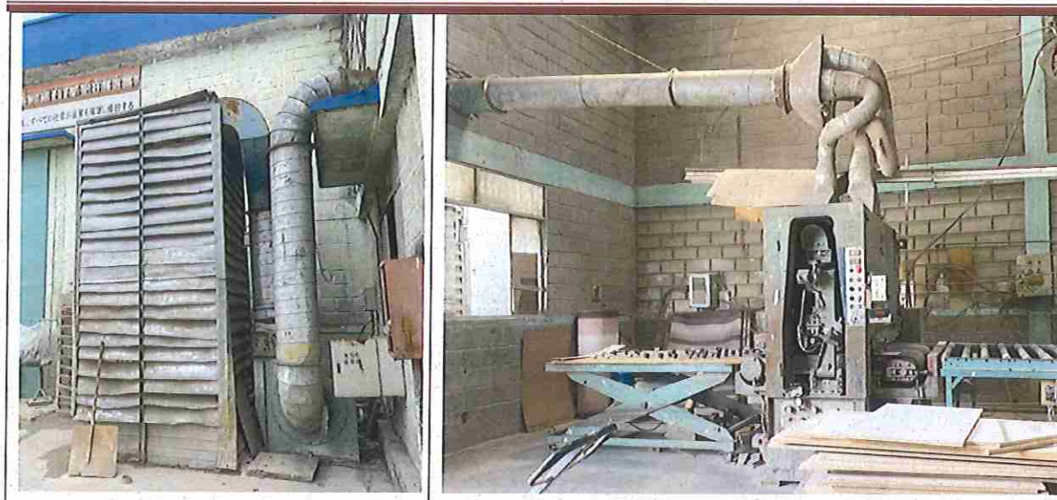
Hình 3. 11. Hệ thống lọc bụi túi vải xử lý bụi gỗ từ công đoạn chà nhám
