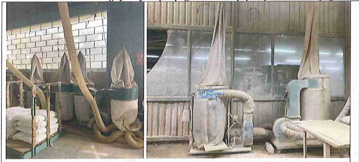
Hình 3. 15. Thiết bị lọc bụi túi vải di động xử lý bụi gỗ từ công đoạn chà nhám Thông số kỹ thuật của hệ thống lọc bụi túi vải như sau:
