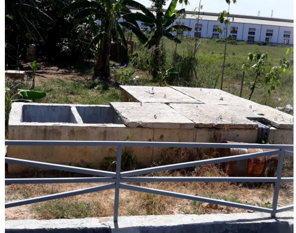
Hình 3.6. Bể tách dầu và bể điều hòa
