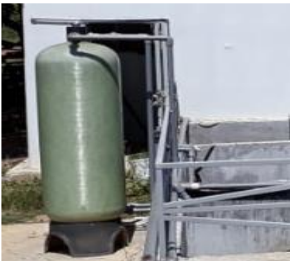
Hình 3.9. Bồn lọc áp lực
