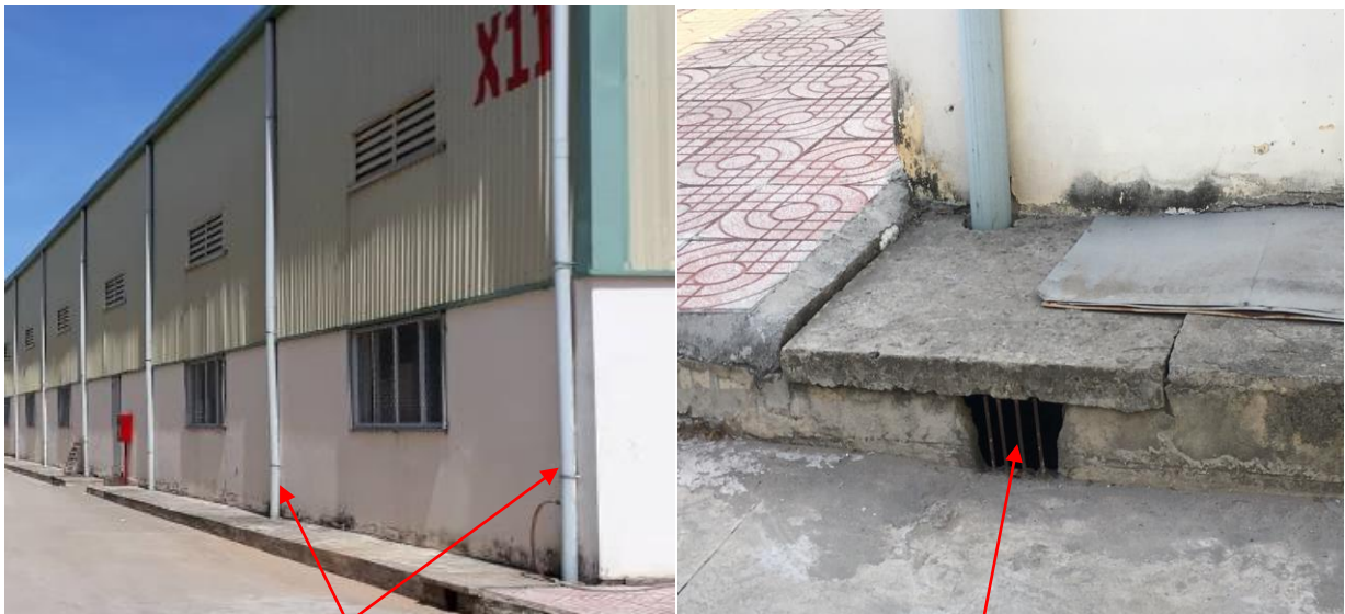
Ống thu gom nước mưa trên mái nhà xưởng
