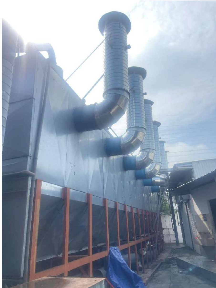
Hình 3.7: Công trình xử lý bụi của Cơ sở
