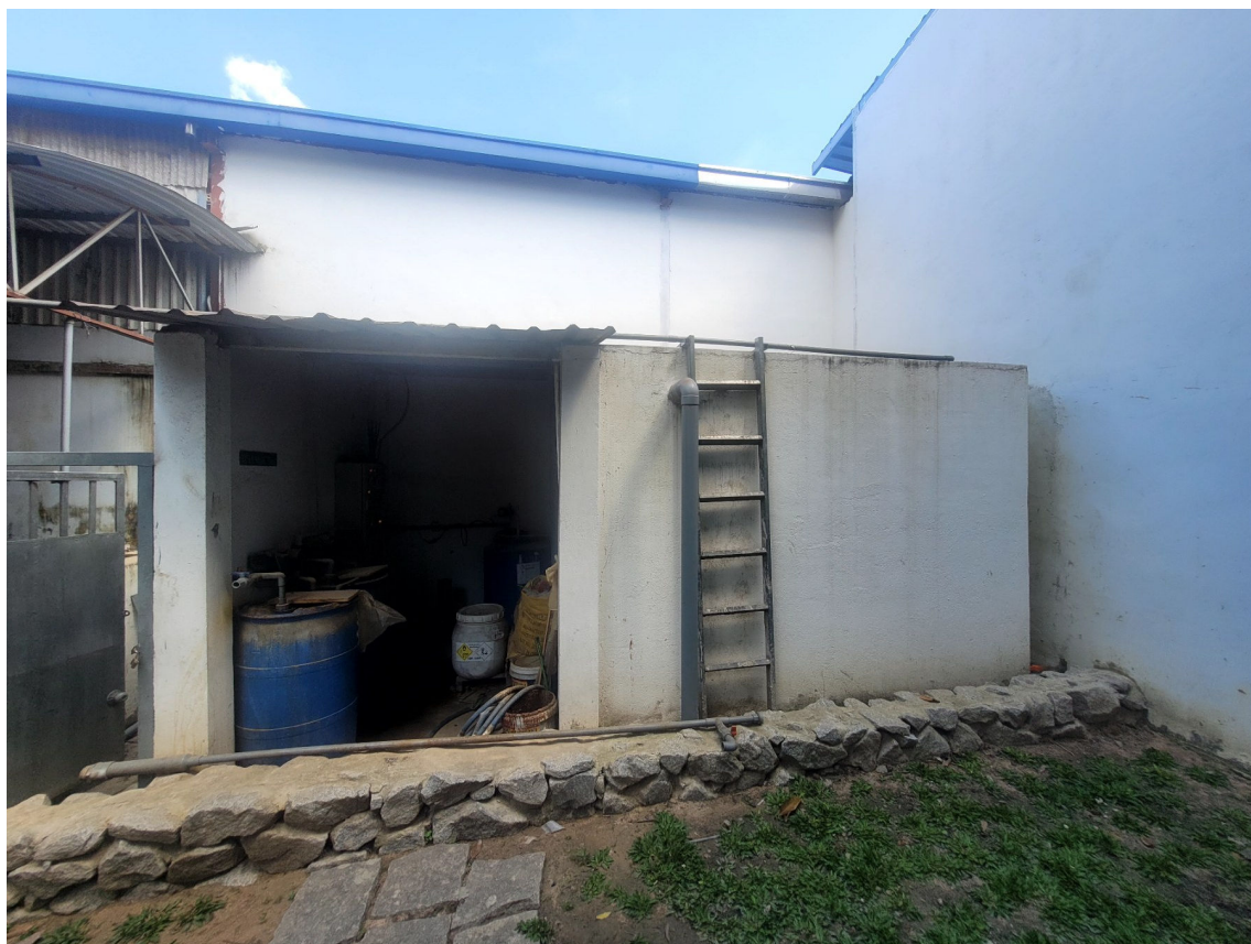
Hình 11 Hệ thống xử lý nước thải Nhà điều hành (Bên trái) và Bể Anoxic (Bên phải)
