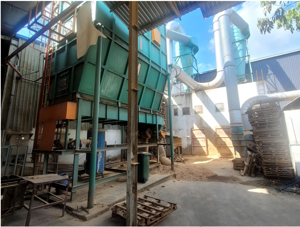
Hình 13 Hệ thống xử lý bụi thải số 01
