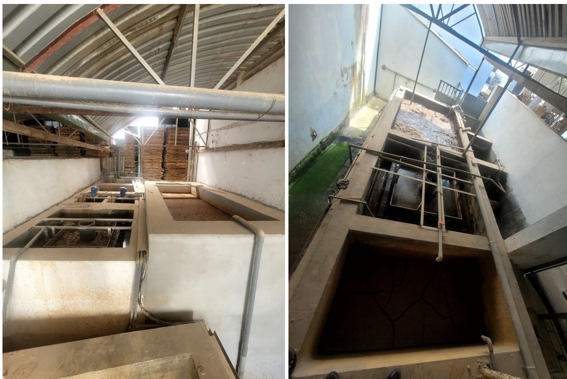
Hình 10 Hệ thống xử lý nước thải Cụm nước thải sản xuất (Bên trái) và Cụm nước thải sinh hoạt (Bên phải)
