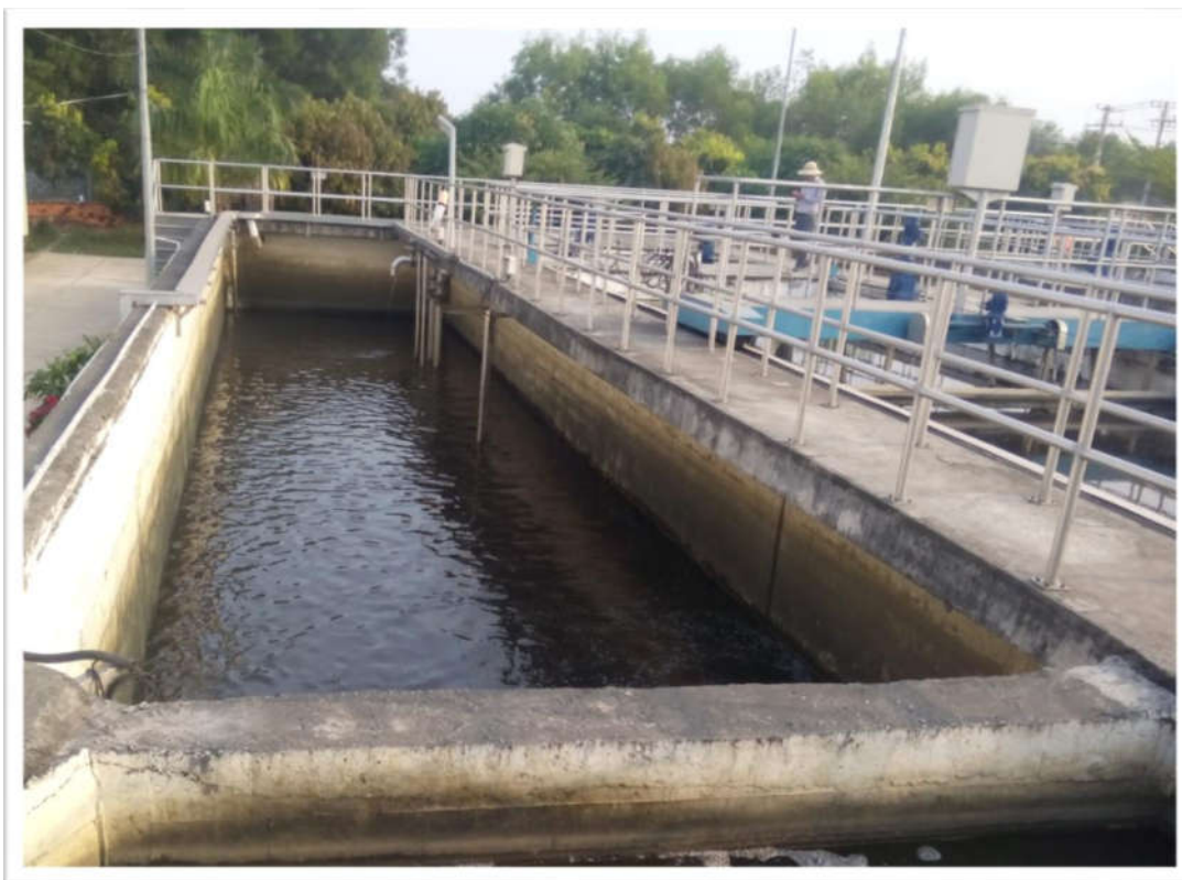
Hình 3. 6. Bể điều hòa
