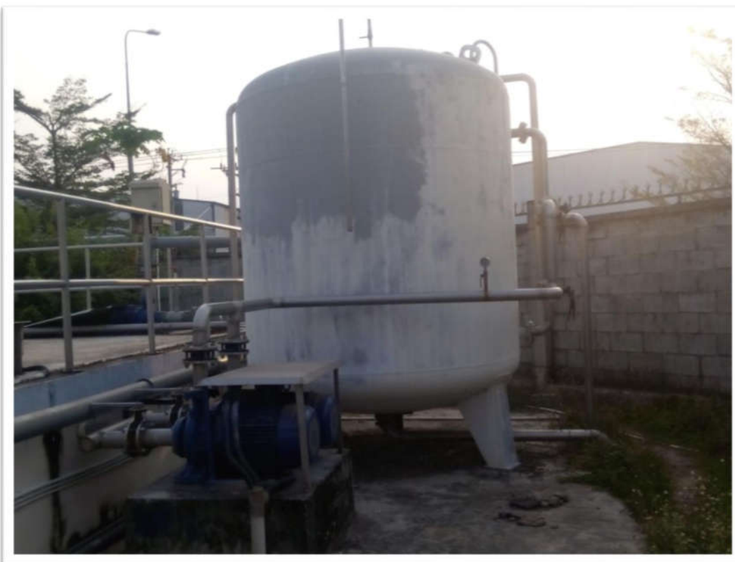
Hình 3. 9. Bồn lọc áp lực
