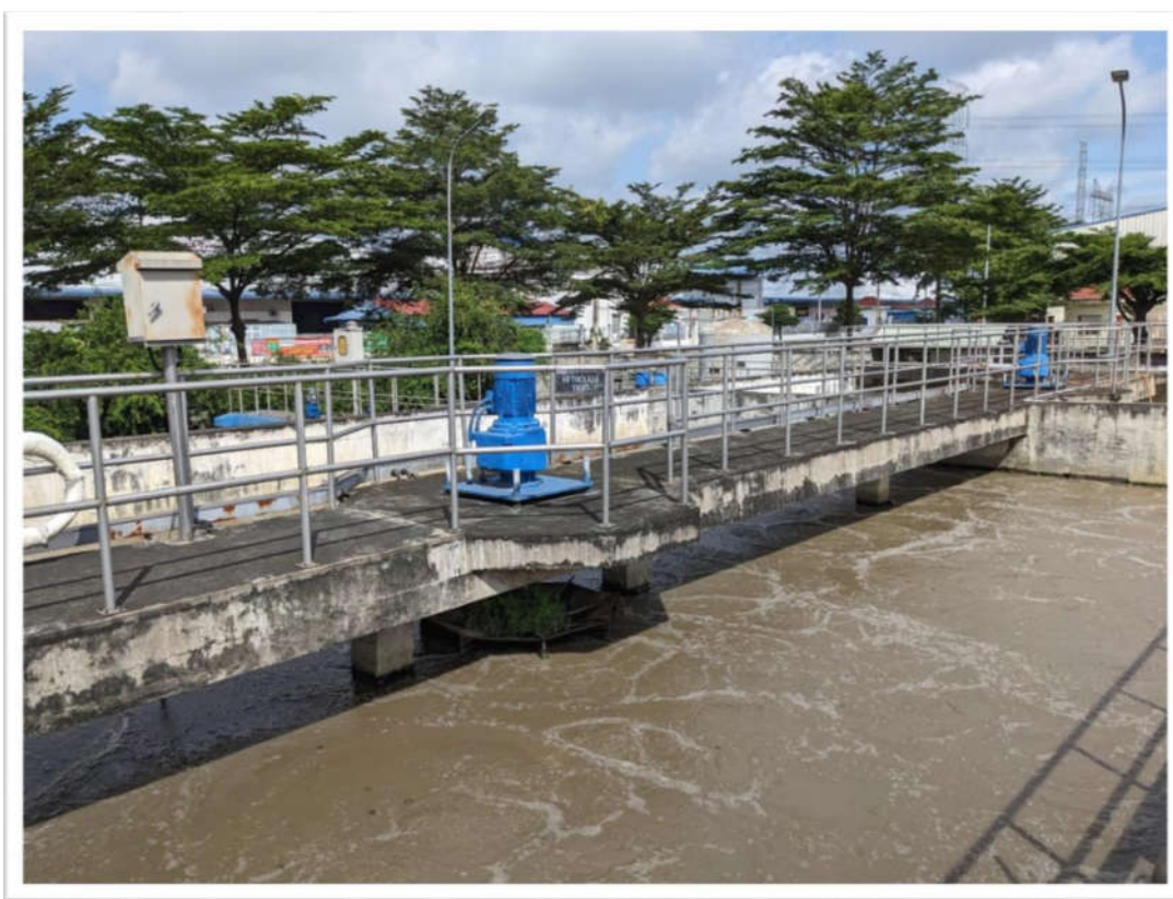
Hình 3. 7. Bể xử lý sinh học
