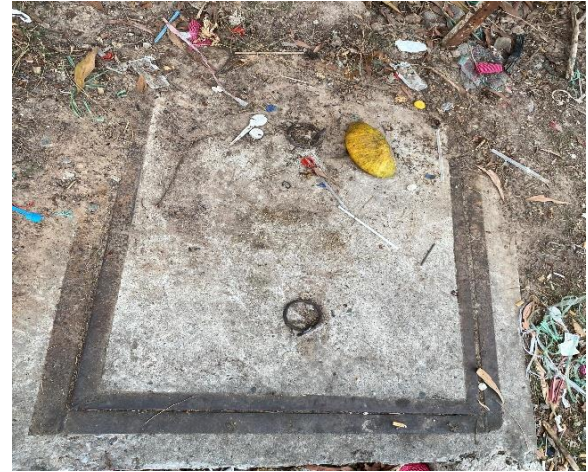
Hố ga đầu nối nước mưa vào hệ thống thoát nước chung đường ĐT741
