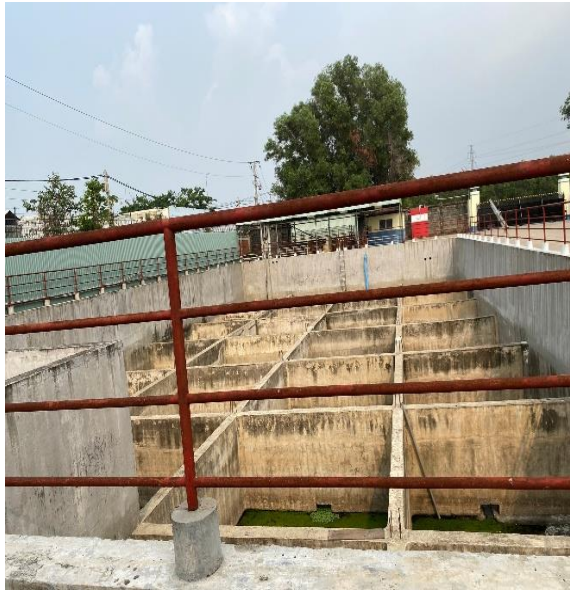
Bể chứa nước mưa
