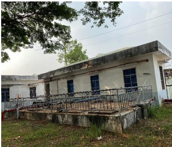
Bể nước PCCC
