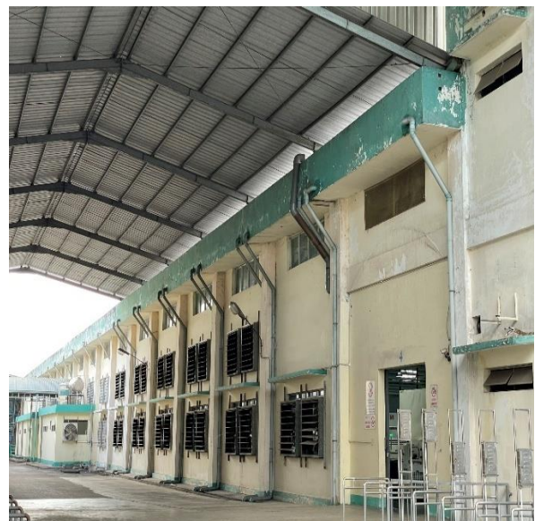
Ống thu gom nước mưa từ mái nhà xưởng
