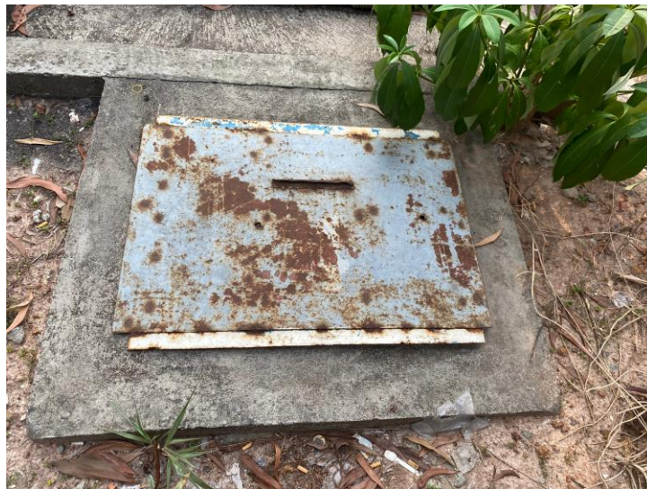
Hình 3. 7. Hố ga đầu nối nước thải vào hệ thống thoát nước chung đường ĐT741
