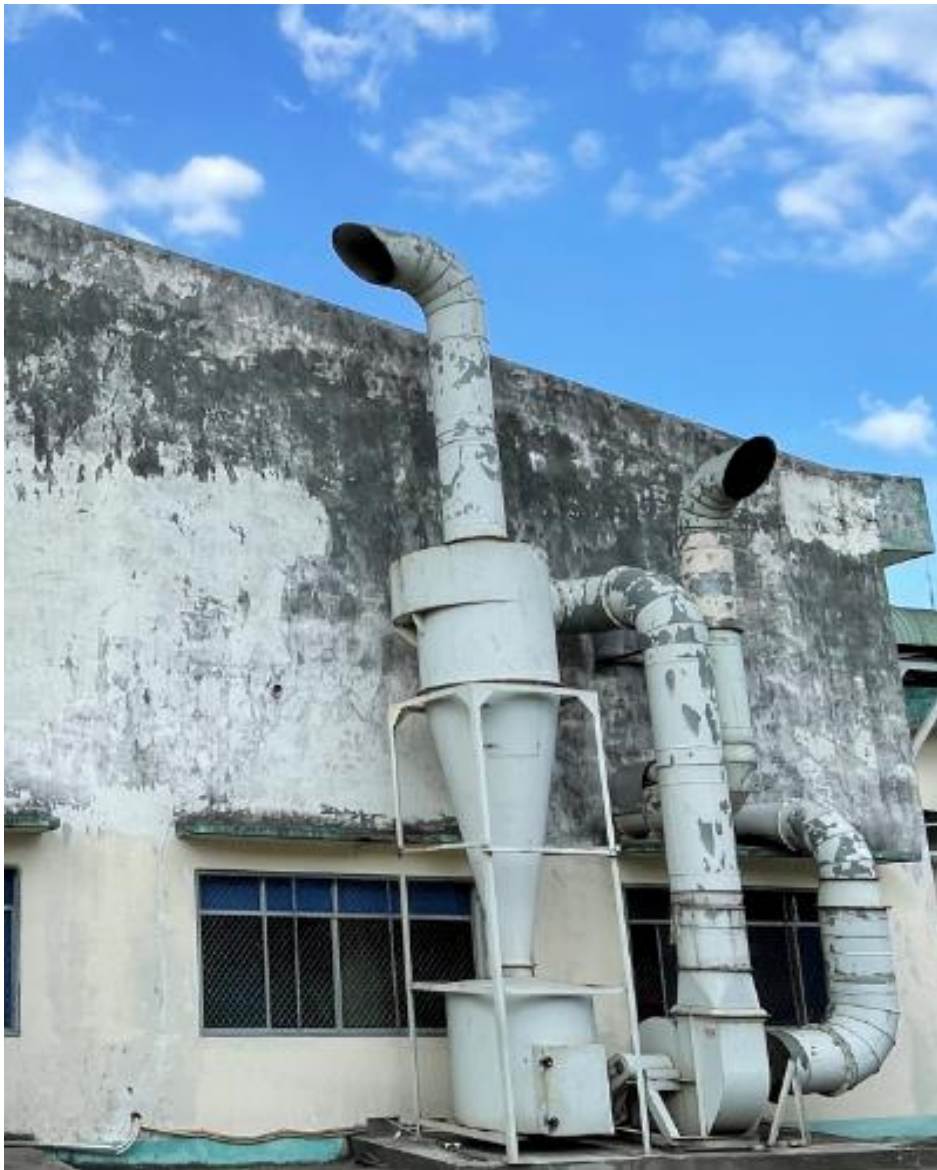
Hình 3. 17. Hệ thống xử lý bụi tại công đoạn mài đế của Công ty
