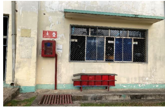
Hệ thống PCCC trang bị tại nhà xưởng
