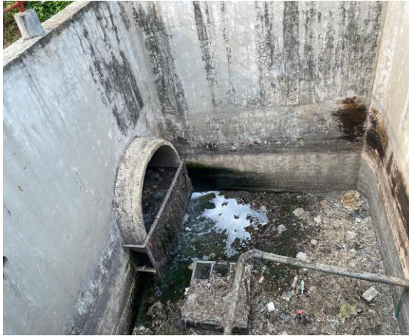
Hệ thống cống ngầm BTCT đường kính D1000m
