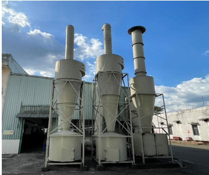
Hình 3. 13. Hệ thống xử lý bụi tại công đoạn mài nhám của Công ty
