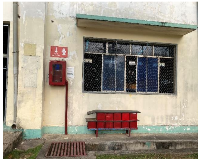
Hệ thống PCCC trang bị tại nhà xưởng
