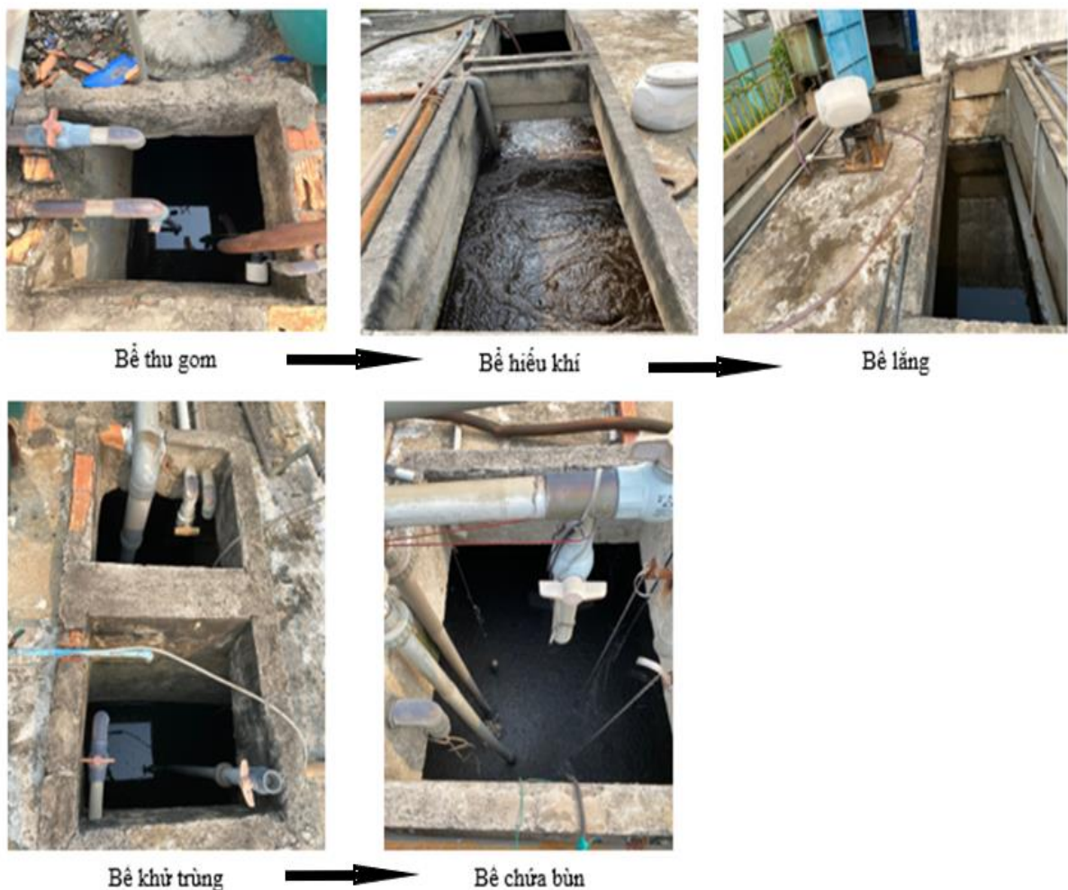
Hình 3. 9. Hệ thống xử lý nước thải số 1 của Công ty
