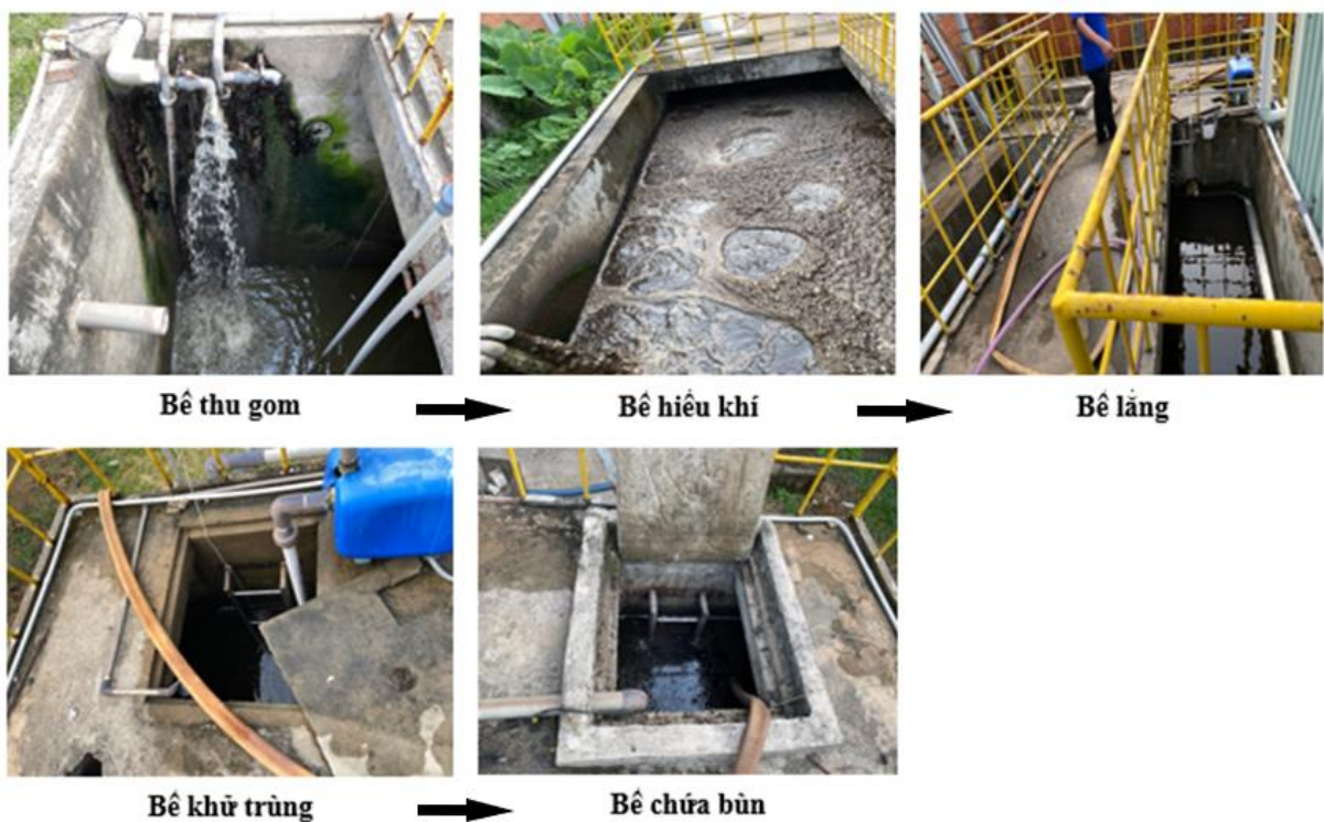
Hình 3. 11. Hệ thống xử lý nước thải số 2 của Công ty
