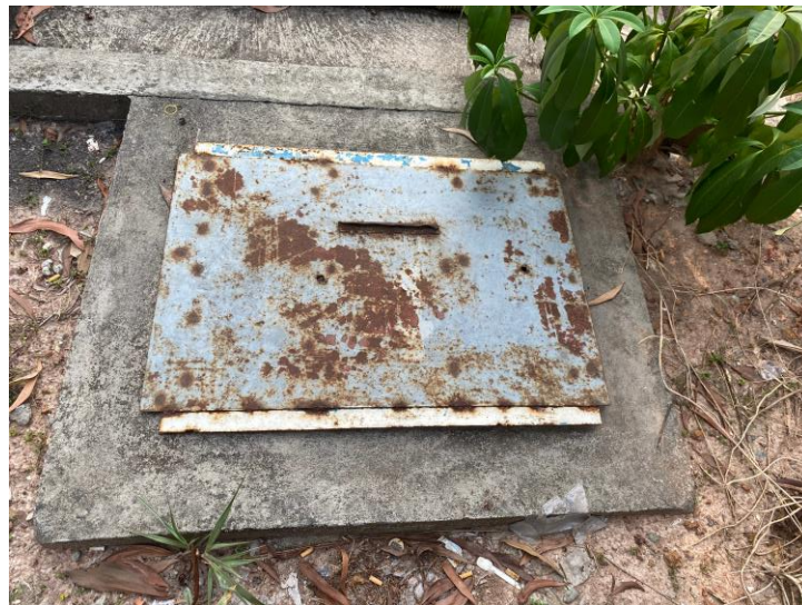
Hình 1. 27. Hố ga đấu nối nước thải vào hệ thống thoát nước chung đường ĐT741
