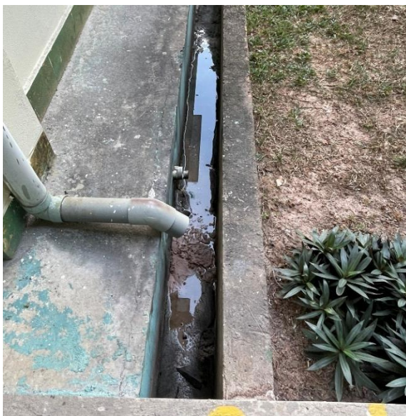
Hệ thống mương hở thu gom nước mưa
