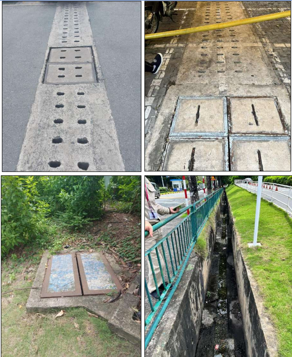
Hình III.2. Hệ thống mương dẫn thoát nước mưa khu vực sân bãi.
