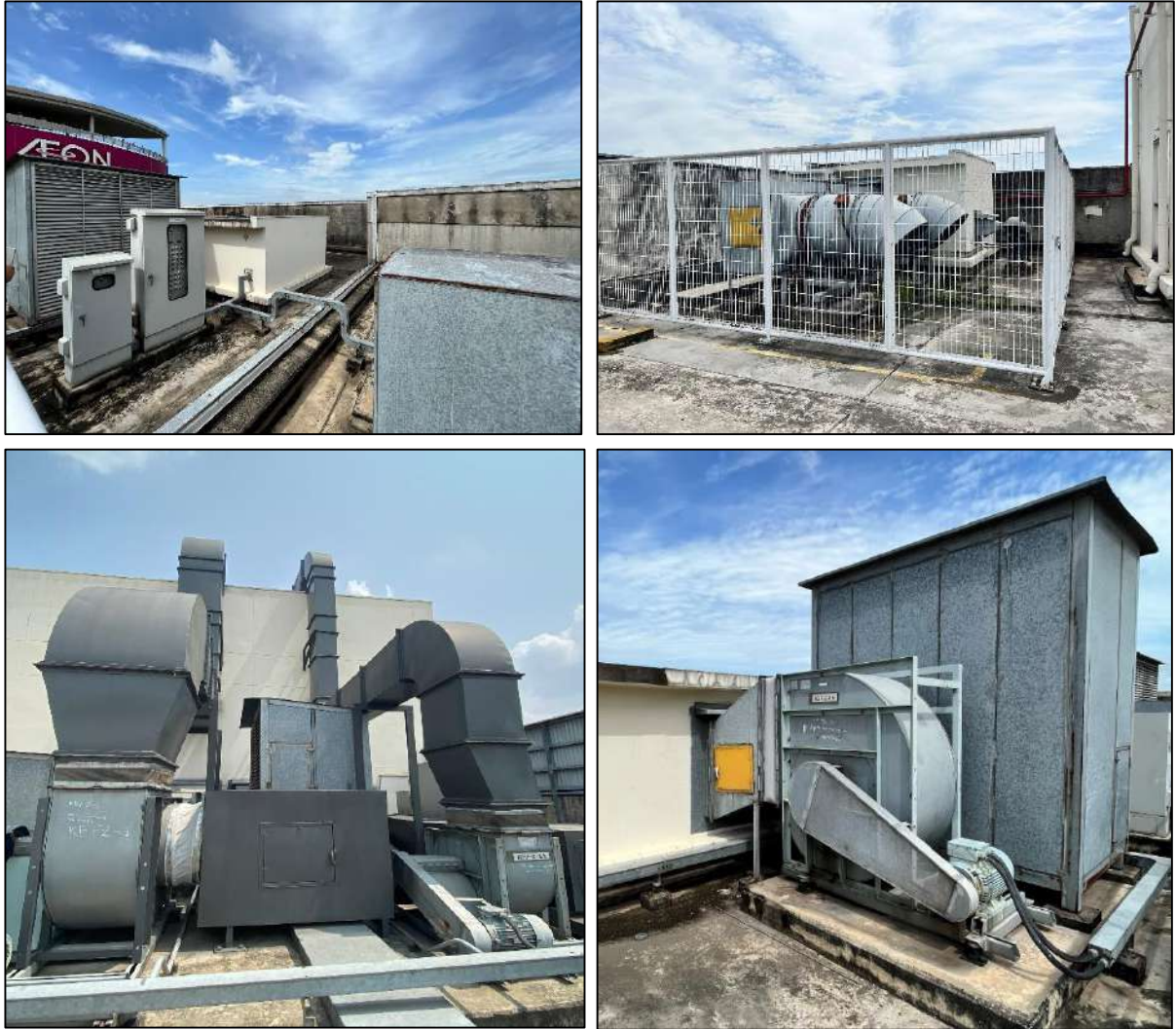
Hình III.12. Hình ảnh hệ thống quạt hút tại cơ sở.
