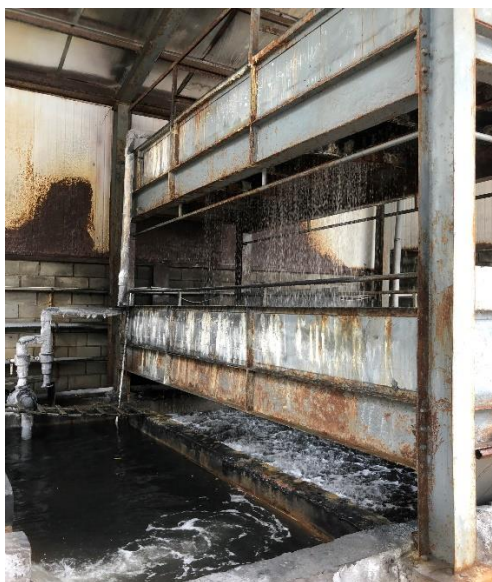
HTXLNT nước thải lò hơi
