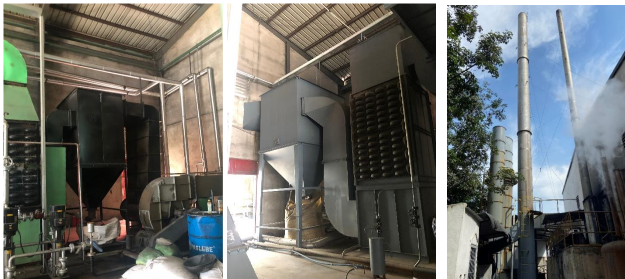
Hình 3. 17. Hệ thống xử lý khí thải lò hơi
