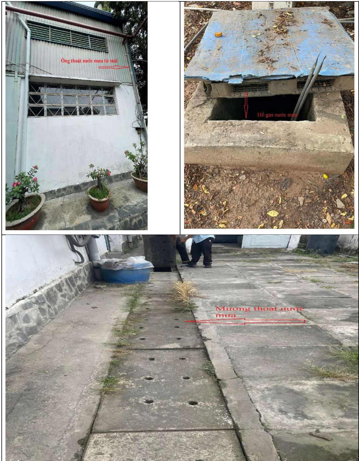
Hình 3.2 Hình ảnh thoát nước mưa cơ sở
