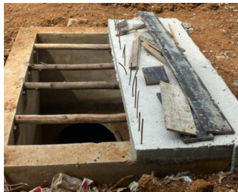
Hố ga đầu nối trên đường Nguyễn Khuyến
