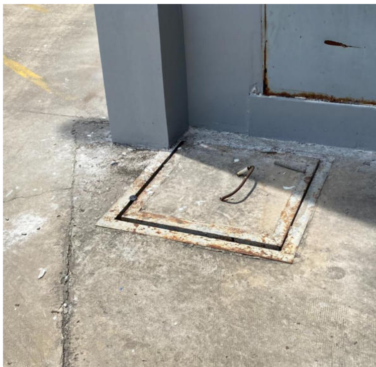
Hình III.4: Hố ga nước thải của cơ sở
