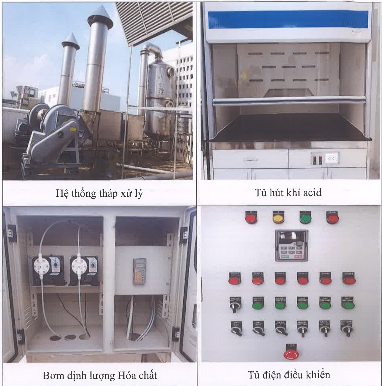
Hình 3-10: Một số hình ảnh hệ thống xử lý khí thải phòng thí nghiệm
