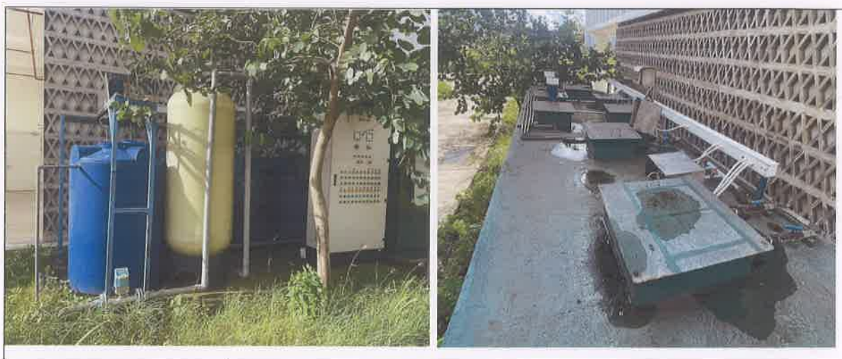
Hình 0-9: Một số hình ảnh khu vực xử lý nước thải phòng thí nghiệm
