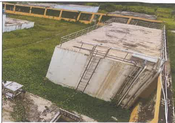
Bể điều hòa
