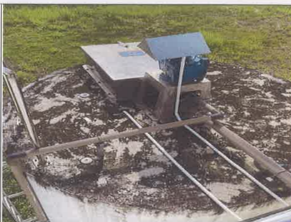
Bể nén bùn
