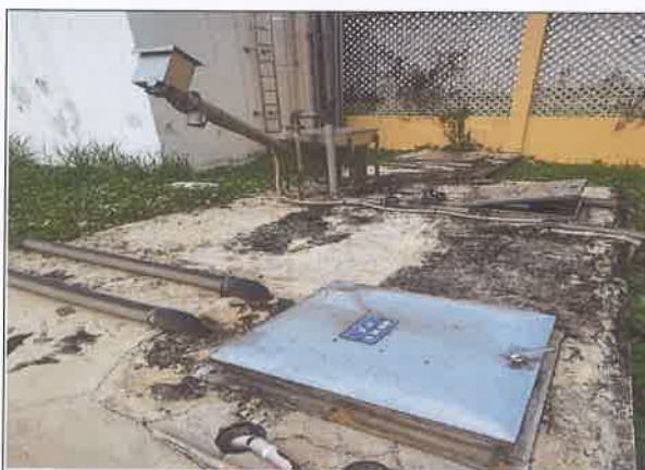
Bể gom và thiết bị tách cát
