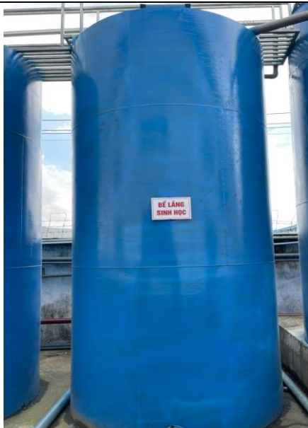
Bể lắng sinh học.
