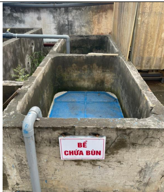
Bể chứa bùn.
