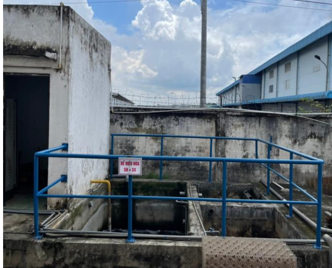
Bể điều hòa NTSX + NTSH.
