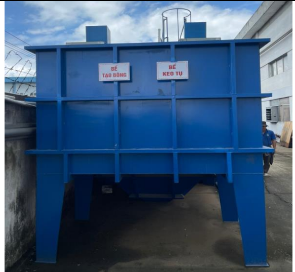
Bể keo tụ - tạo bông.
