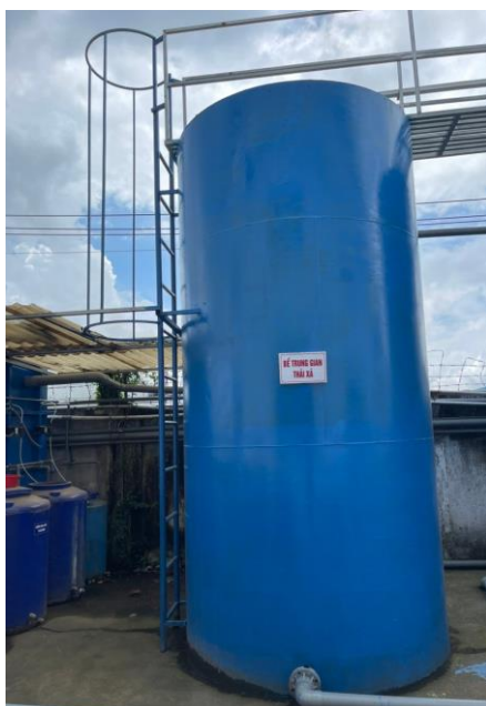
Bể trung gian – khử trùng.
