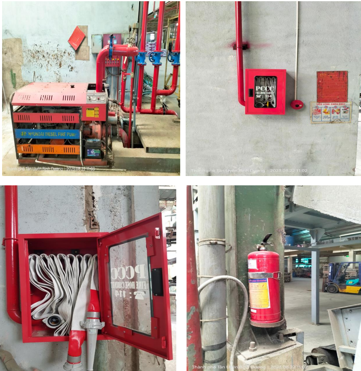
Hình 3. 12. Một số hình ảnh thiết bị phòng cháy chữa cháy
