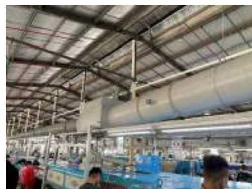
Hệ thống xử lý khí thải hơi dung môi từ quá trình quét keo – gia công đế giày (Nhà máy 1)
