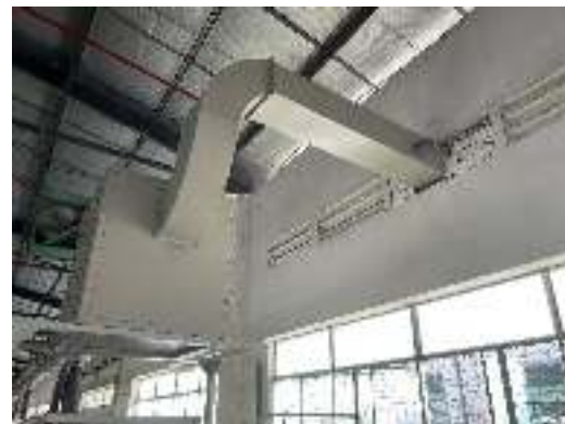
Hệ thống xử lý khí thải hơi dung môi từ quá trình quét keo – gia công đế EVA (Nhà máy 1)
