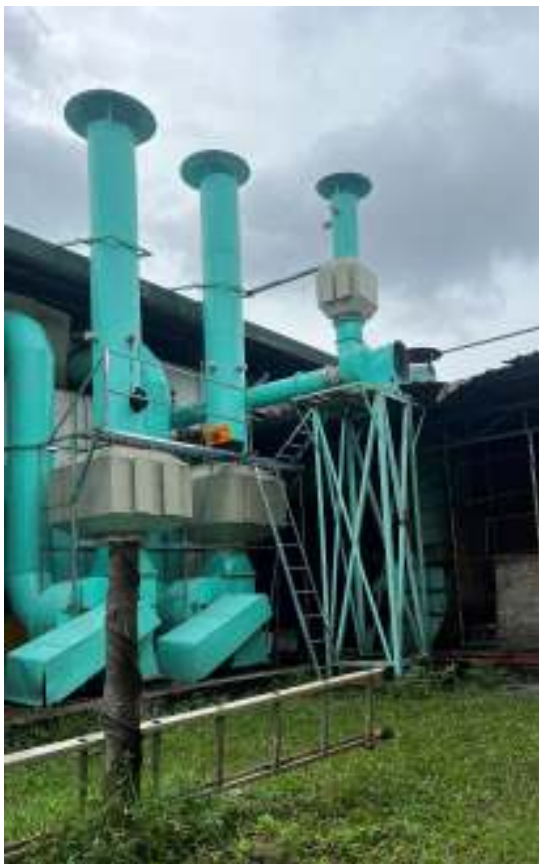
Hệ thống xử lý khí thải hơi dung môi từ quá trình quét keo – gia công giày thành phẩm (Nhà máy 1)
