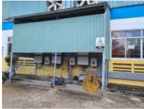
Trạm điện năng lượng mặt trời tại Nhà máy 2
