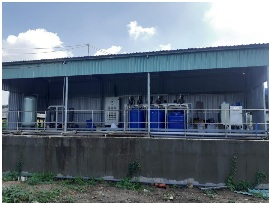
Hình 3. 9. HTXLNT công suất 120 m 3 /ngày đã xây dựng tại Cơ sở
