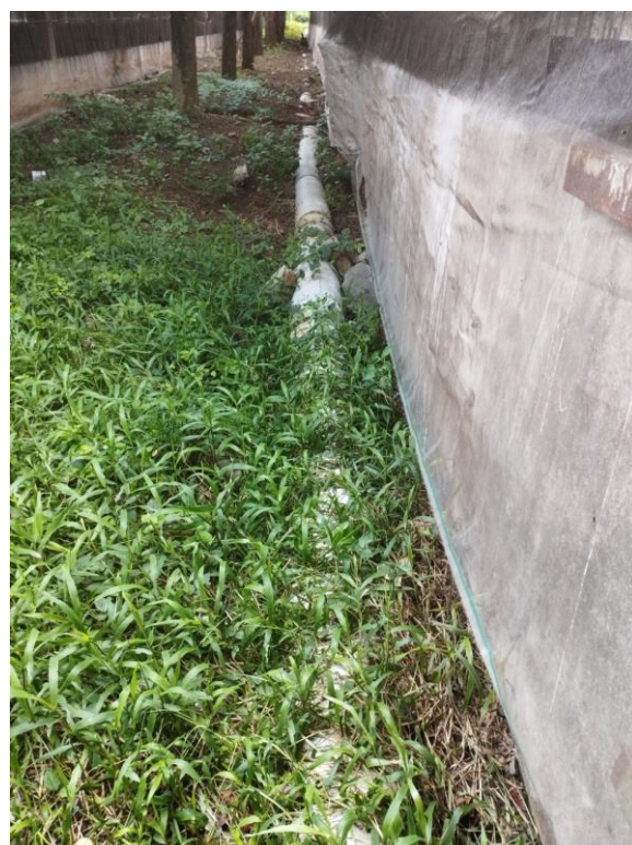
Hình 3. 4. Đường ống dẫn nước thải chăn nuôi bên ngoài chuồng
