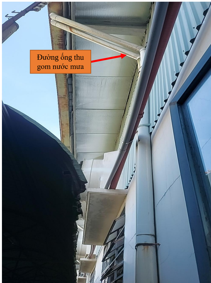
Hình 3. 1. Đường ống thu nước mưa từ trên mái.
