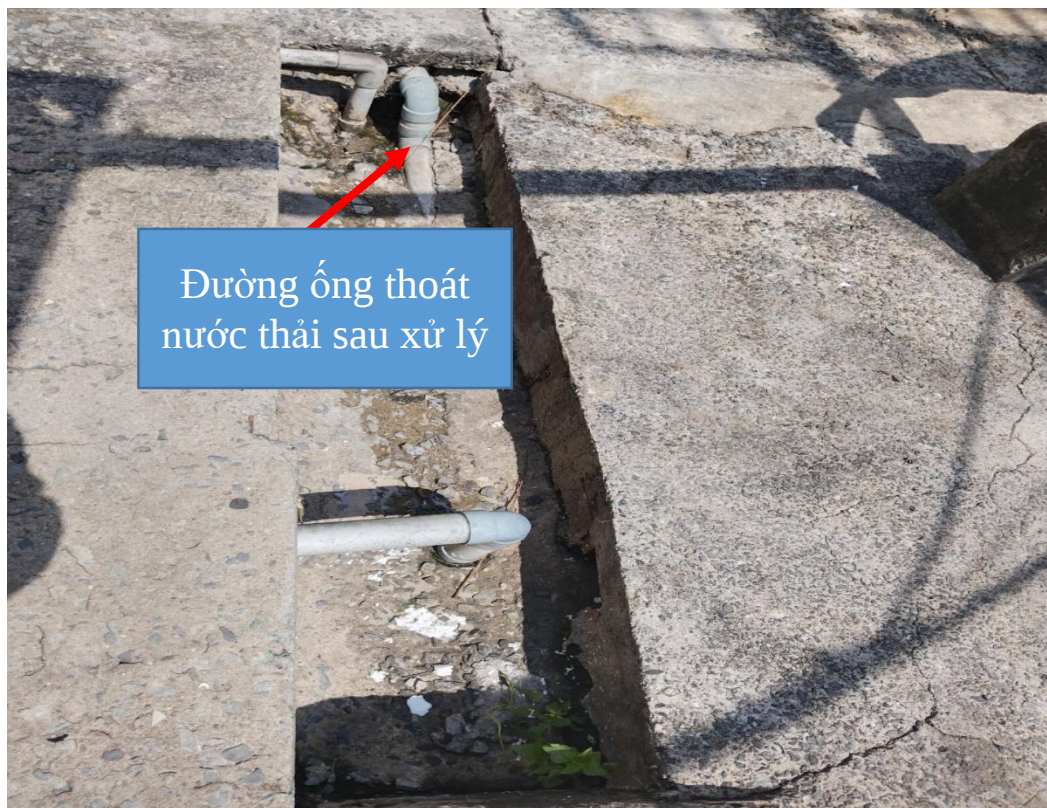
Hình 3. 6. Đường ống thoát nước thải sau xử lý.
