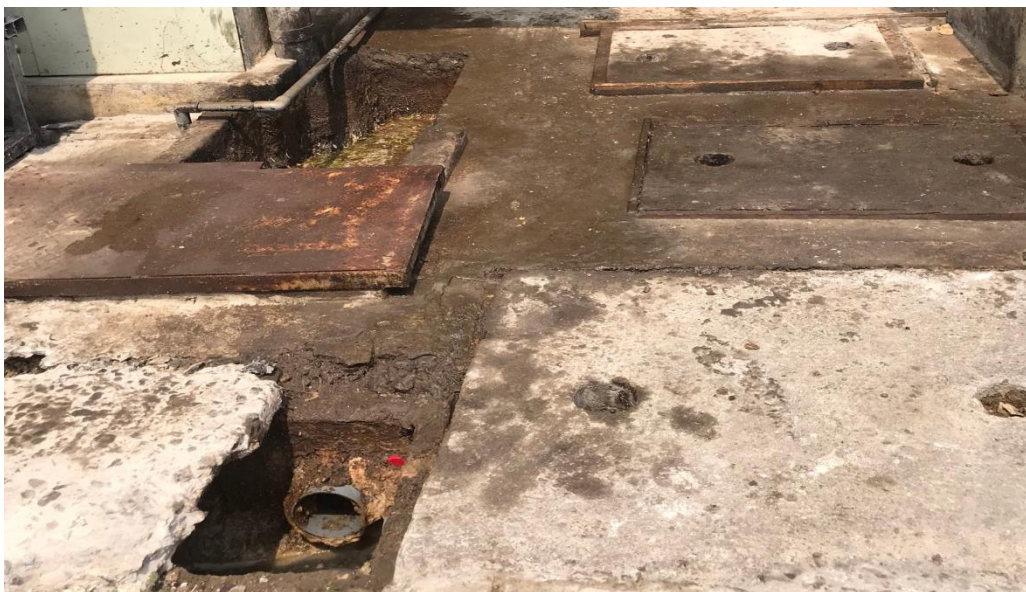
Hình 3. 9. Bể tách mỡ của nhà máy
