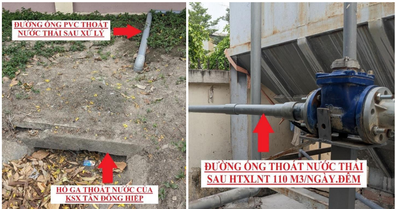
Hình 3. 6. Hố ga đầu nối nước thải vào hệ thống thoát nước của KSX Tân Đông Hiệp
