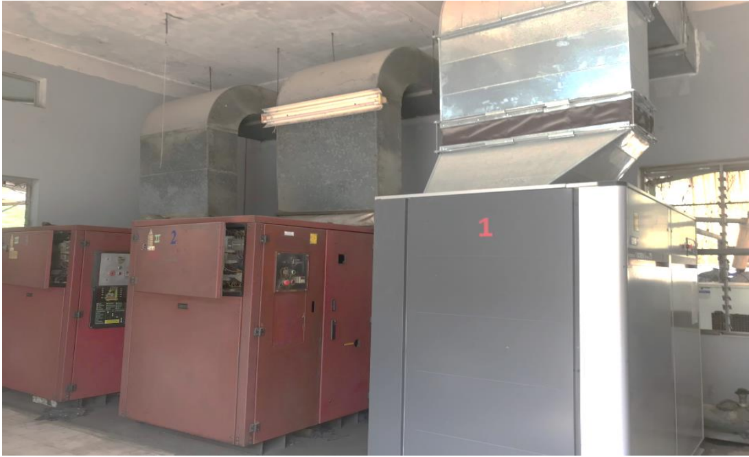
Hình 3. 20. Khu vực đặt máy phát điện của nhà máy
