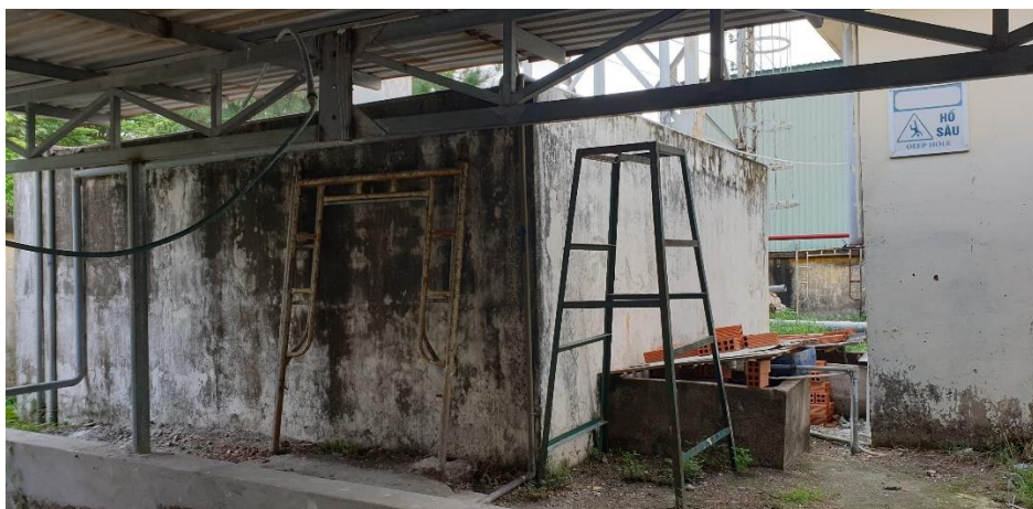
Cụm Bể điều hòa sinh hoạt- Bể Anoxic- Bể Aerotank
