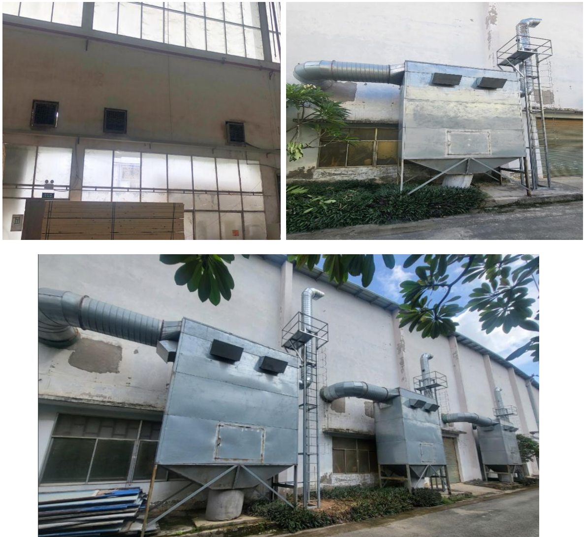
Hình 3.9. Hệ thống thông thoáng nhà xưởng và thu gom bụi phía bên ngoài nhà xưởng số 4
