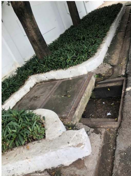
Hình 3. 2. Mương thoát nước mưa chung của Công ty TNHH Liên Anh (trước cổng Công ty Cổ phần Wendelbo Đông Nam Á)
