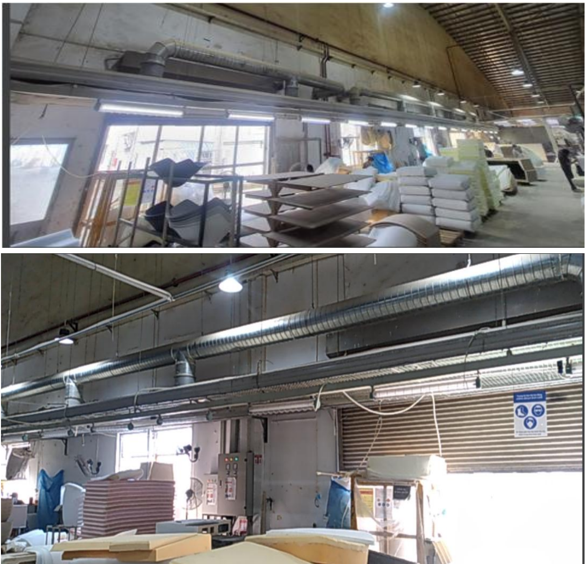
Hình 3.12. Hệ thống hút khí tại công đoạn dán keo ghế sofa (máng hút phía trong và quạt con hơi dung môi ngoài nhà xưởng số 4)
