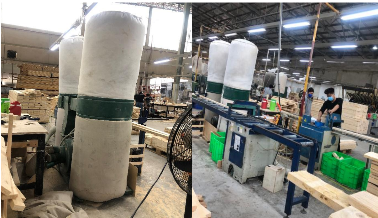
Hình 3.7. Các quạt hút bụi gỗ hiện hữu tại nhà máy
