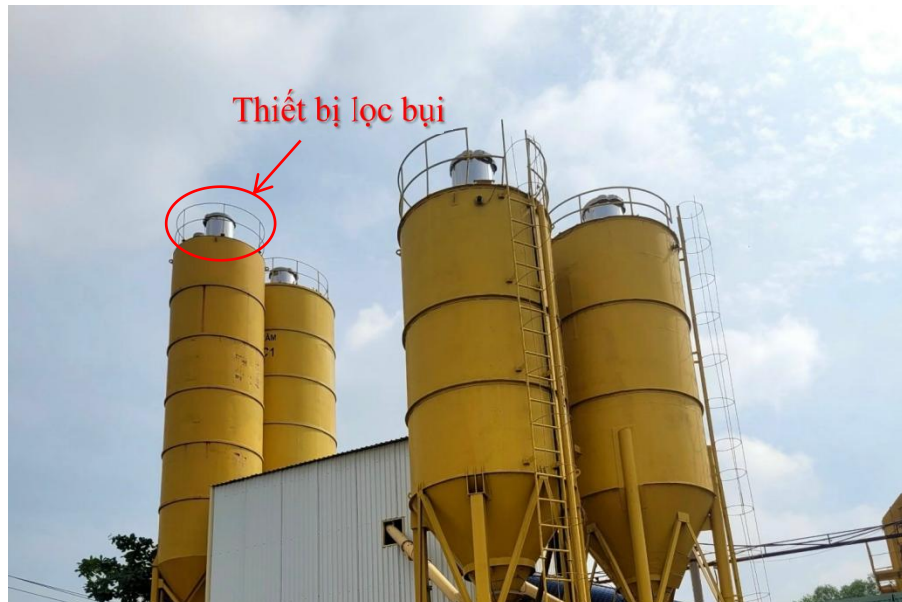
Hình 3.6. Hệ thống lọc bụi dạng túi vải của bồn chứa xi măng
