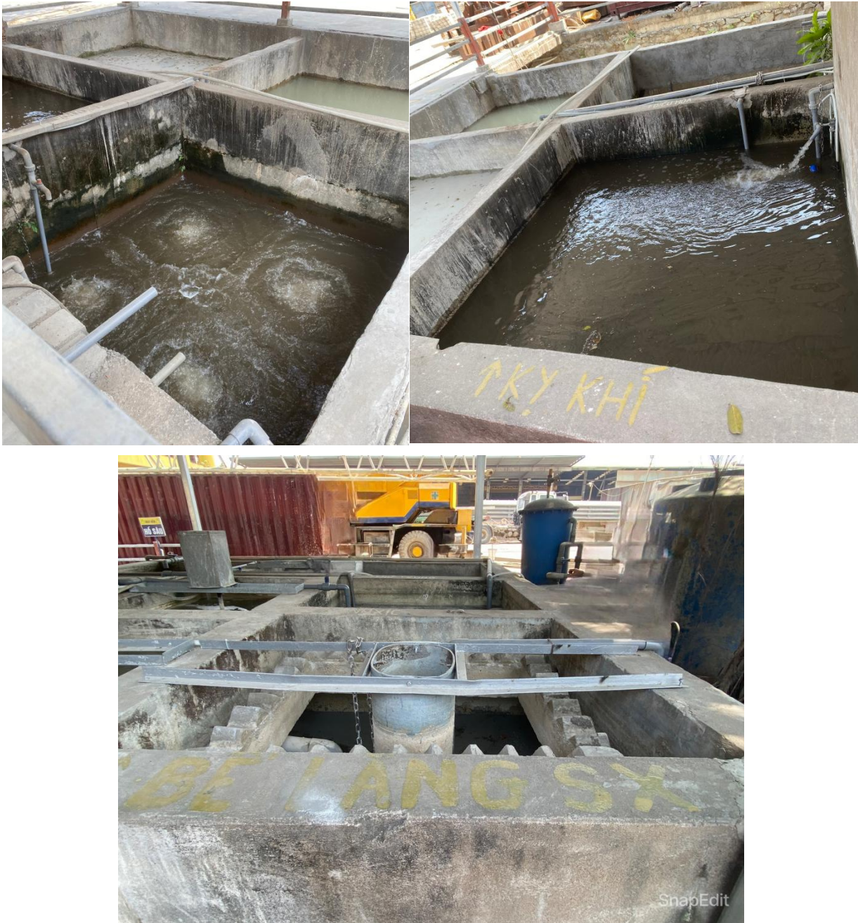
Hình 3.3. Hình ảnh thực tế tại HTXL nước thải của Nhà máy
