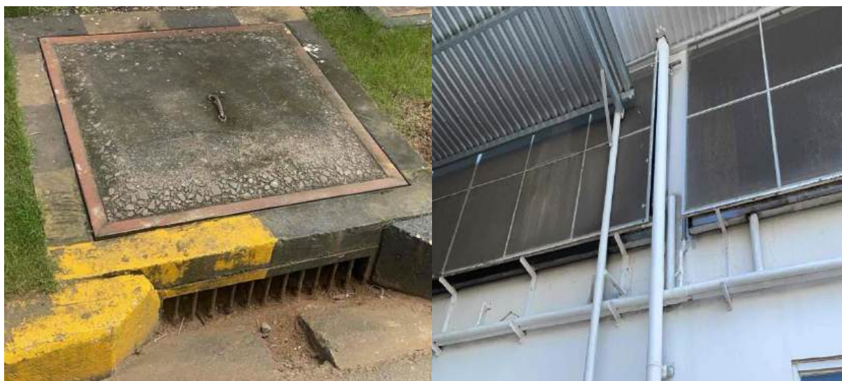
Hình 3. 5. Ống thu gom nước mưa trên mái và cống thoát nước mưa của Cơ sở
