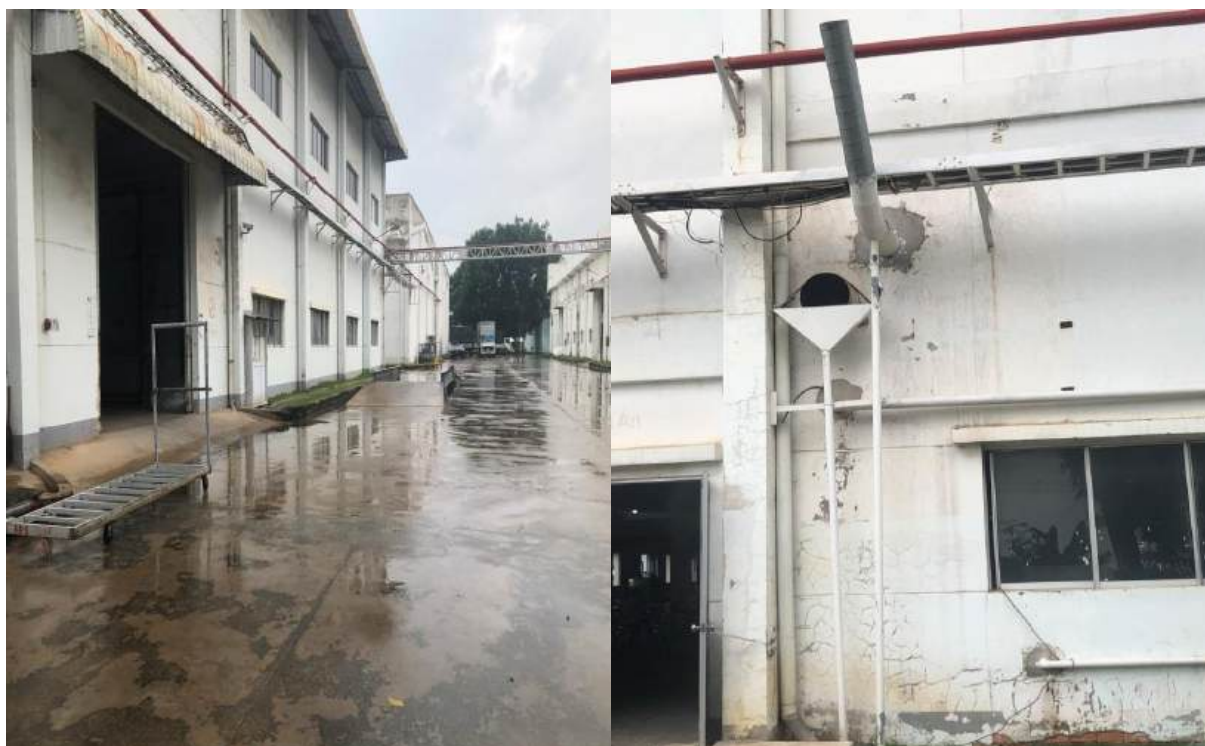
Hình 3. 3. Ống thu gom nước mưa trên mái
