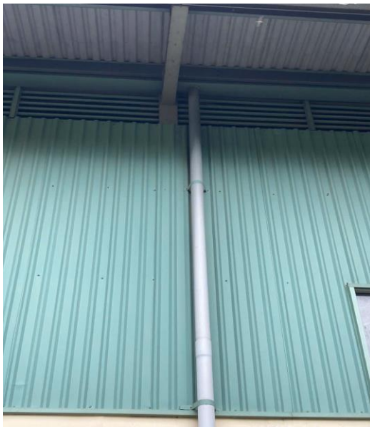
Hệ thống thu gom nước mưa mái nhà
