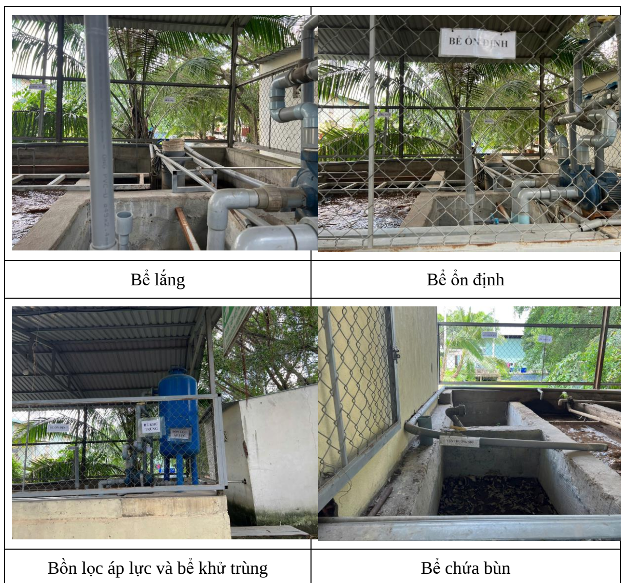
Hình 3. 8. Hệ thống xử lý nước thải, công suất 50 m 3 /ngày.đêm
