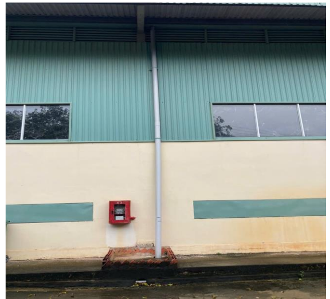
Hệ thống thu gom nước mưa xung quanh nhà xưởng, văn phòng
