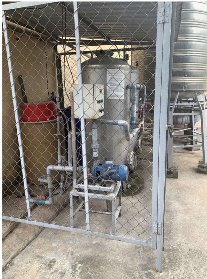
Hình 1. 11. Hình ảnh hệ thống làm mềm nước của Công ty
