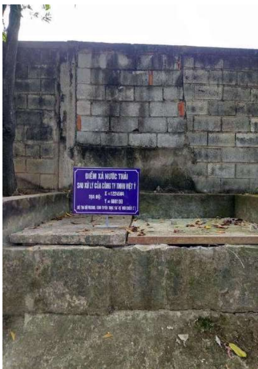
Hình 3.4. Hồ ga thoát nước thải của Công ty trên đường Nam Cao
