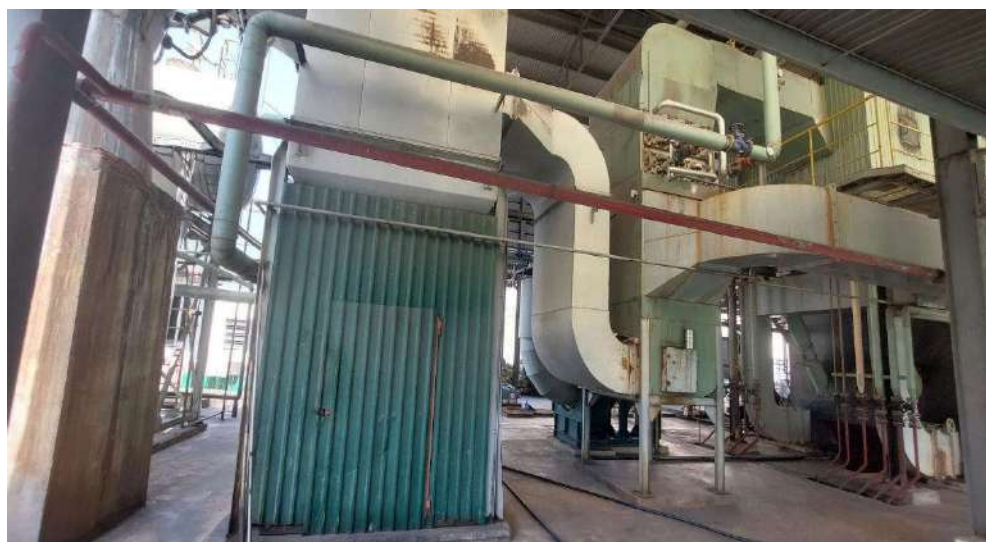
Hình 3. 9. Hình ảnh hệ thống xử lý khí thải lò hơi
