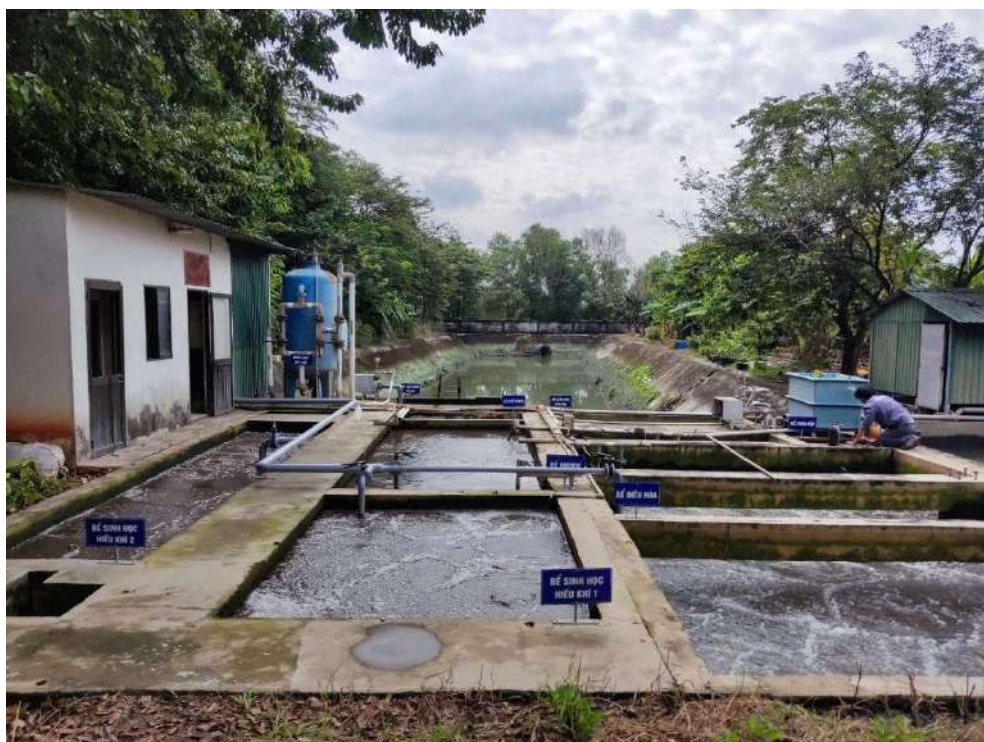
Hình 3.7. Hình ảnh hệ thống xử lý nước thải của Công ty
