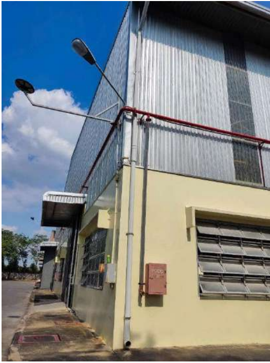
Ống thoát nước mưa trên mái
