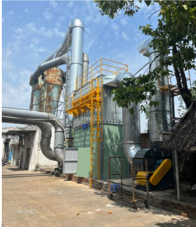
Hình 3. 7. Hệ thống xử lý bụi gỗ khu vực cưa, cắt, bào
