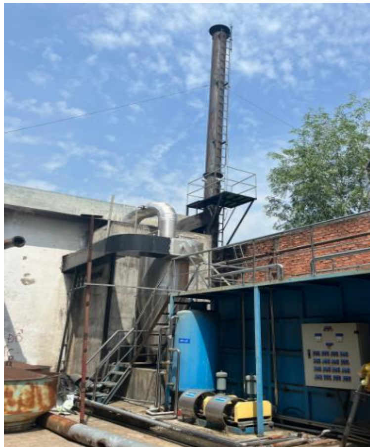
Hình 3. 9. Hệ thống xử lý khí thải lò hơi
