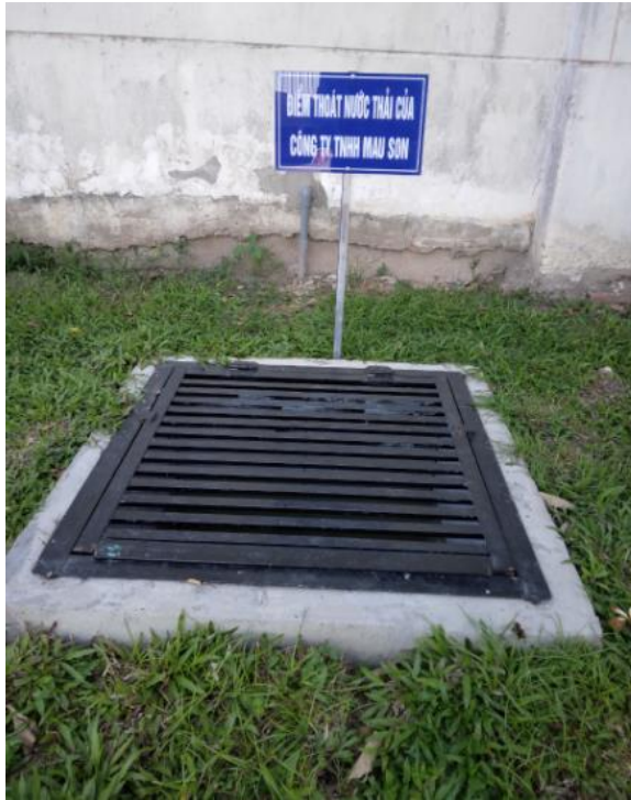
Hình 3. 5. Hố ga thoát nước thải của cơ sở
