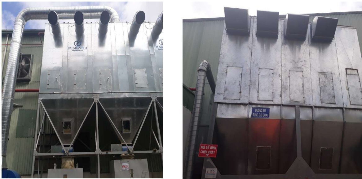
Hình 3.8. Hệ thống thu gom bụi
