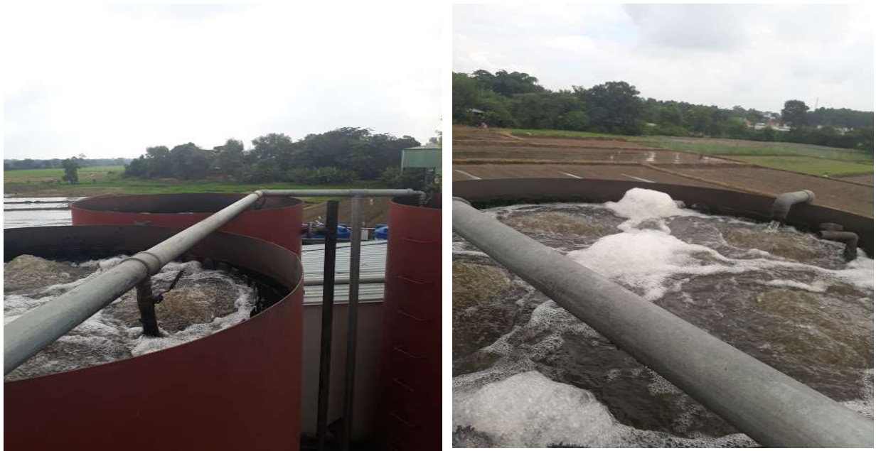
Hình 3.6. Hệ thống XLNT tập trung của công ty
