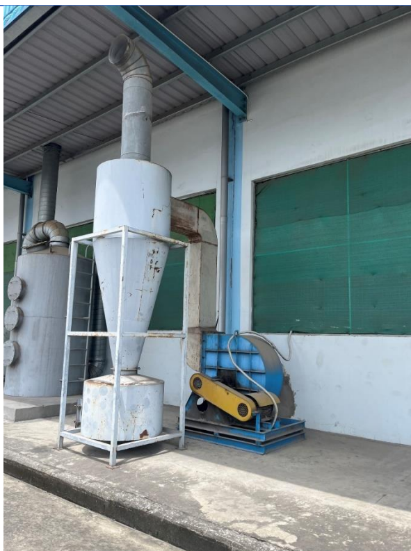
Hình 3.11. Hệ thống Cyclone thu gom bụi từ công đoạn mài đế giày
