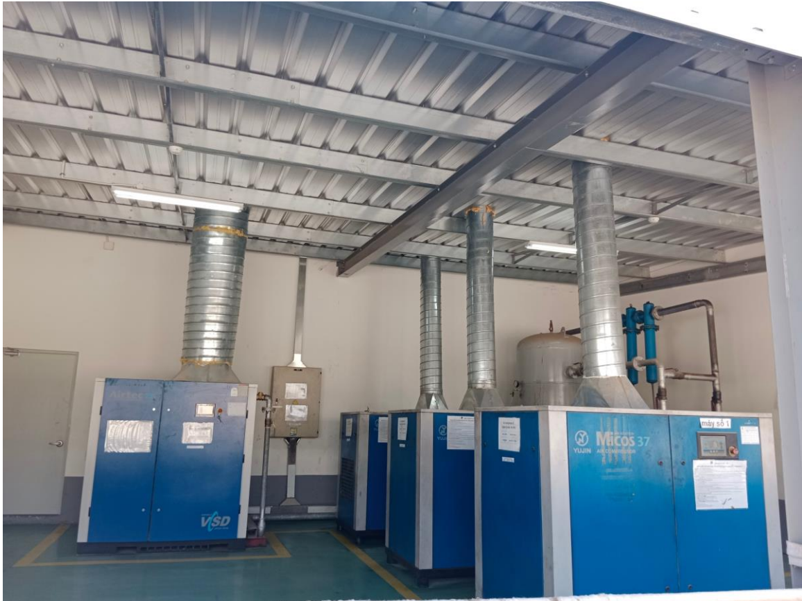
Hình 3.21. Ống thải của máy nén khí tại cơ sở
