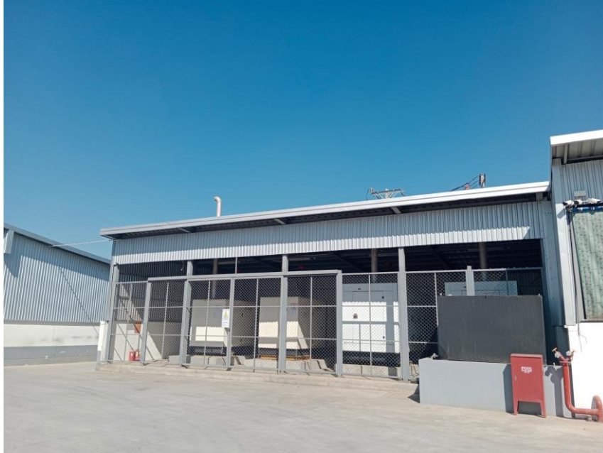
Hình 3.16. Khu vực máy phát điện
