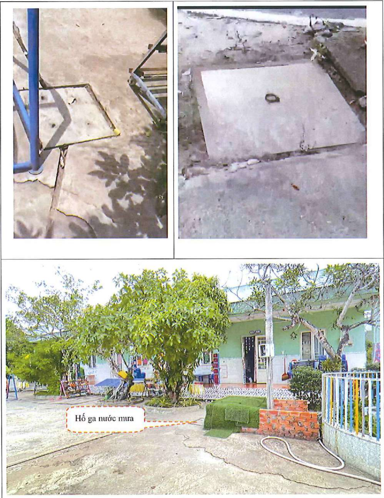
Hình 1-11: Hồ ga thu gom nước mưa của trường hiện hữu
