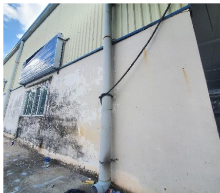
Hình 2. 3. Đường ống thu gom nước mưa từ trên mái nhà xưởng
