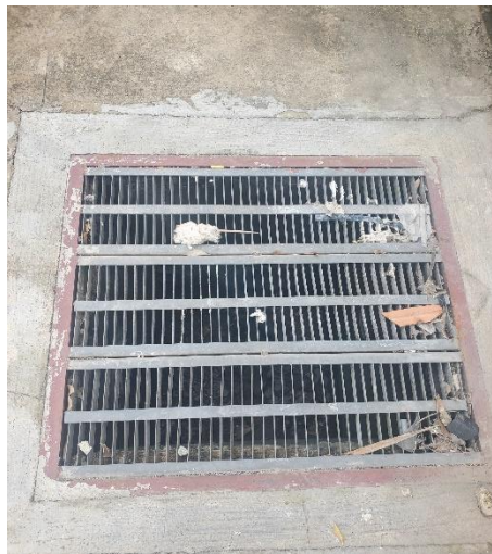
Hình 2. 2. Hố ga thoát nước mưa trong khuôn viên dự án
