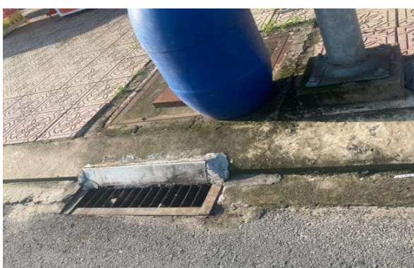
Hố ga thu gom nước mưa
