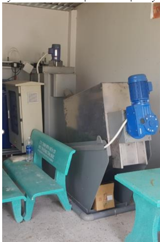
Hình 3. 5. Máy ép bùn đã được đầu tư tại dự án
