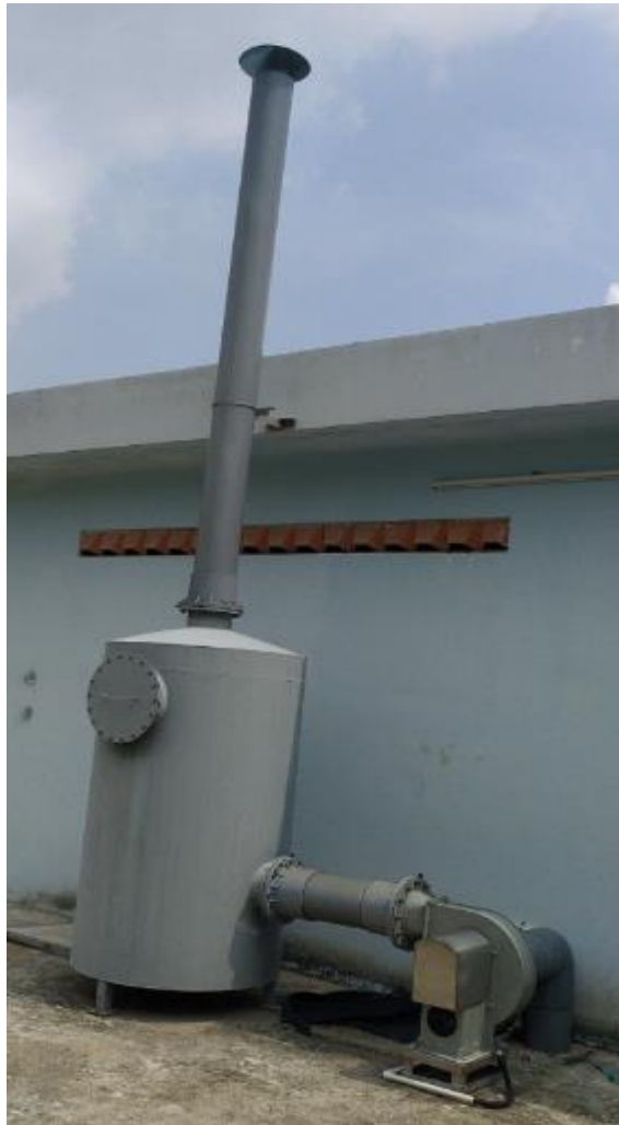
Hình 3. 8. Hệ thống xử lý khí thải đã được lắp đặt tại dự án
