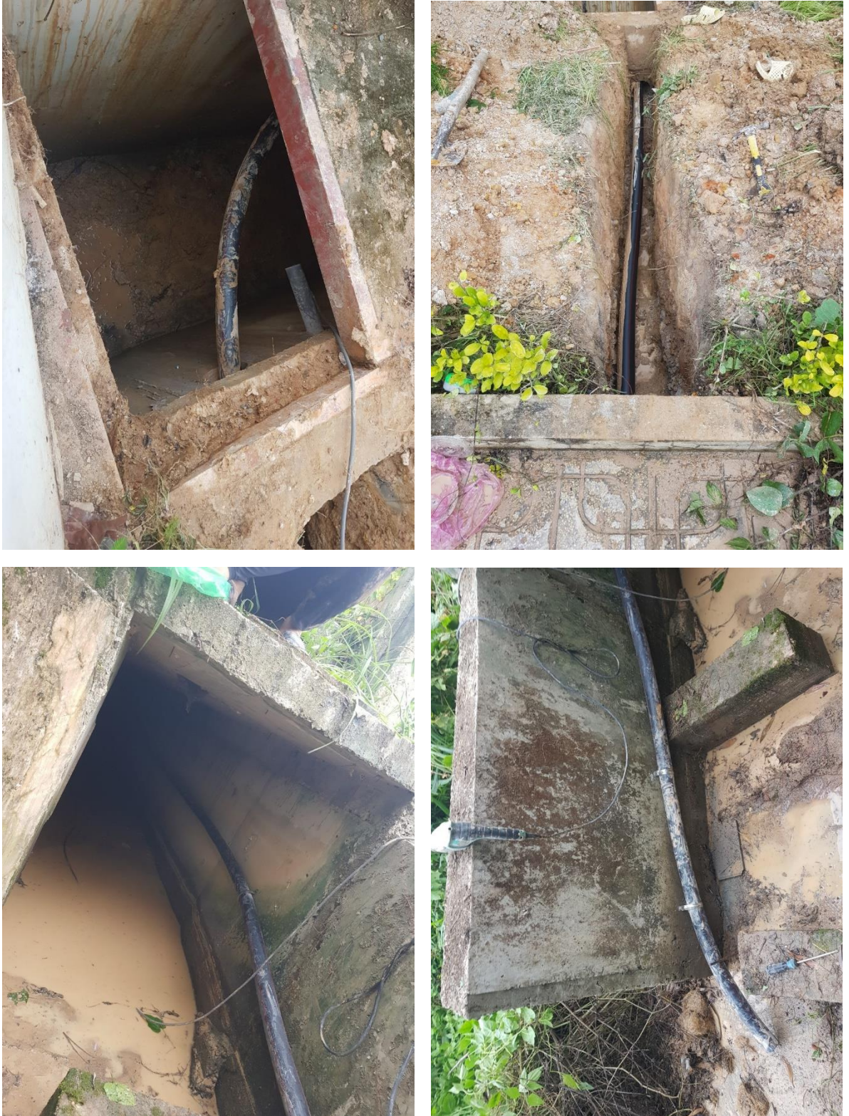
Hình 1. 7. Đoạn cống thoát nước mưa và nước thải sau xử lý đã được đầu tư xây dựng tách riêng
