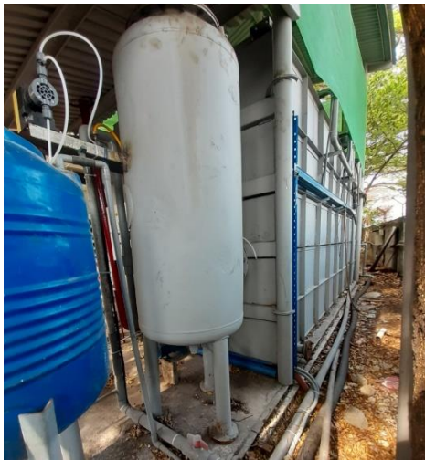
Bồn lọc áp lực
