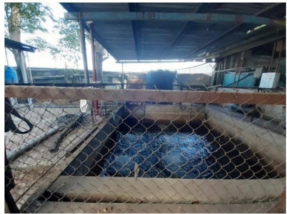
Bể điều hòa
