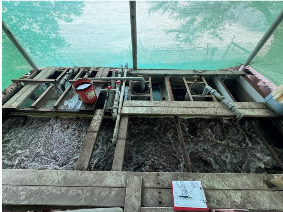
Thiết bị hợp khối (cụm bể anoxic - aerotank - bể lắng - bể trung gian)
