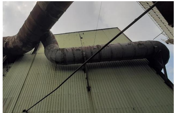
Đường ống thu gom khí thải
