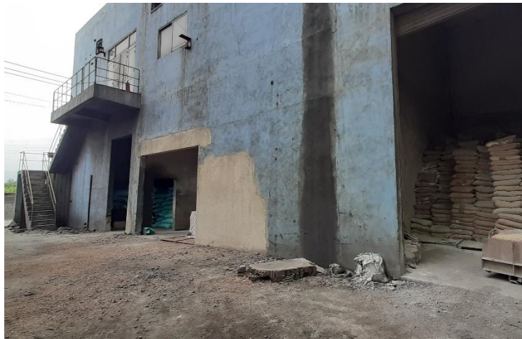
Hình 3. 14: Công trình kho chất thải tại nhà hệ thống bù trung thế
