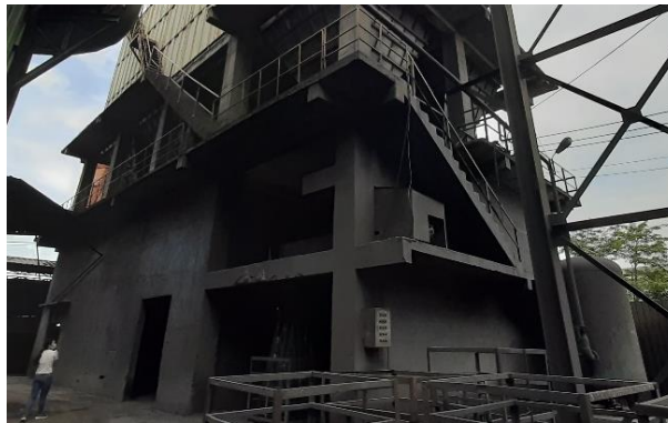
Công trình xử lý khí thải
