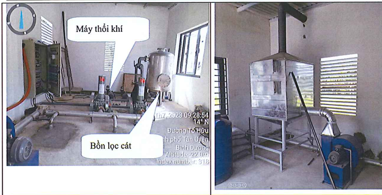
Hình 3-5: Thiết bị của hệ thống XLNT
