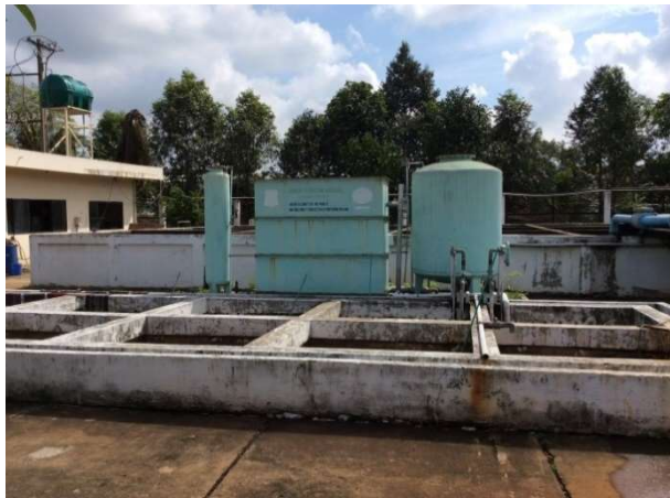
Hình 1.7. Trạm xử lý nước thải công suất 50 \text{ m}^3/\text{ngày.đêm} .
