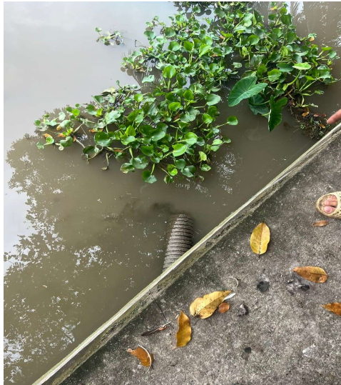
Hình 3. 6. ống thoát nước thải sau xử lý ra rạch Trầu
