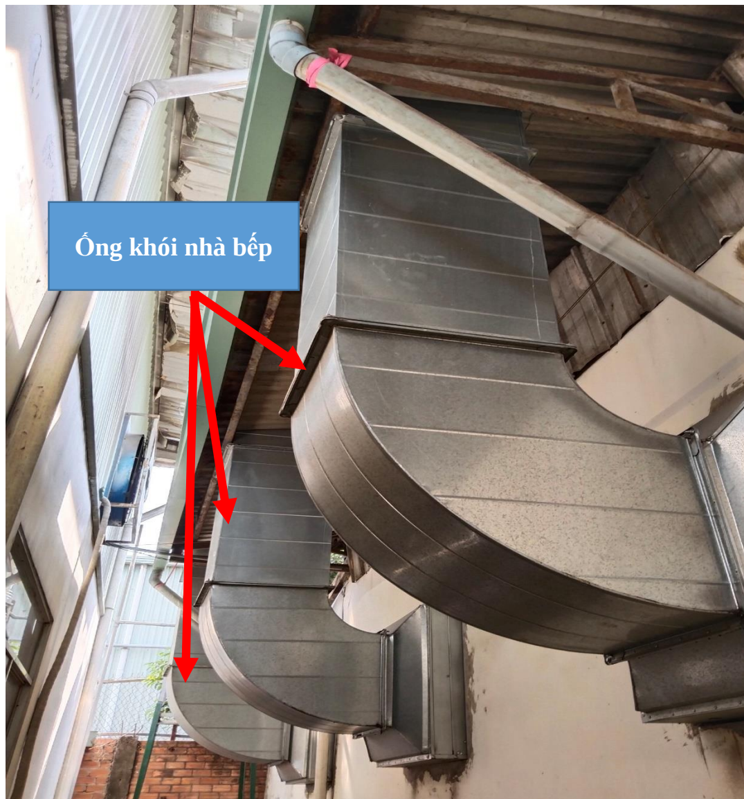
Hình 3. 10. Hình ảnh ống khói nhà bếp.
