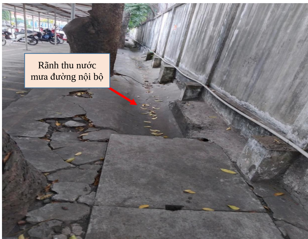
Hình 3. 3. Rãnh thu nước mưa đường nội bộ
