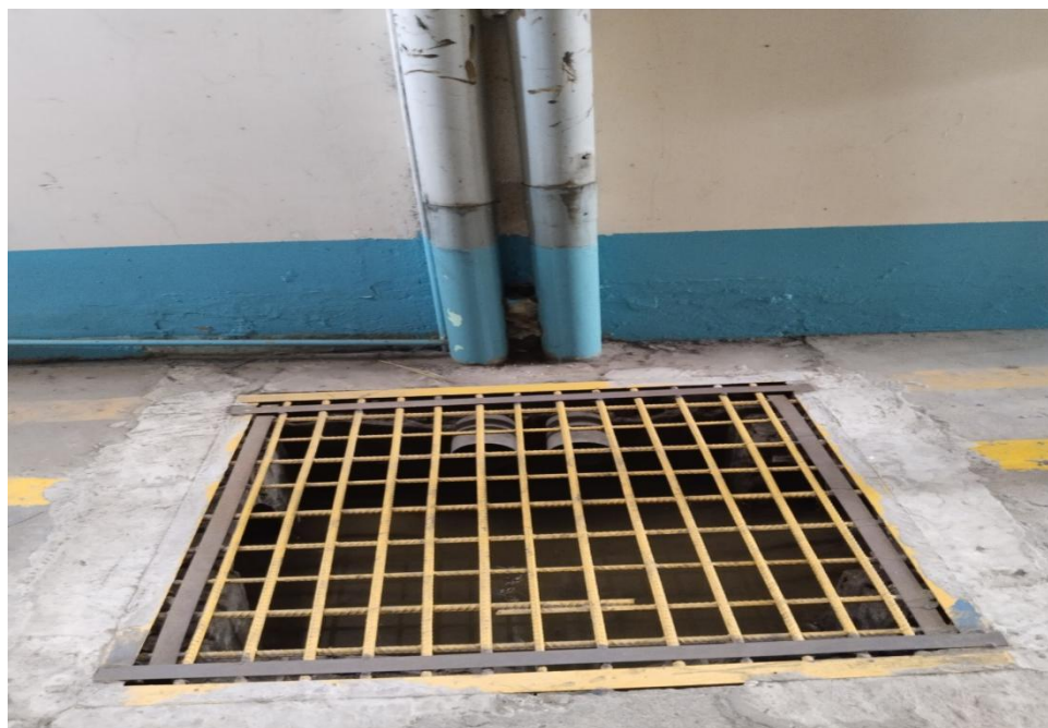
Hình 3. 2. Hố ga thu gom nước mưa từ mái nhà.
