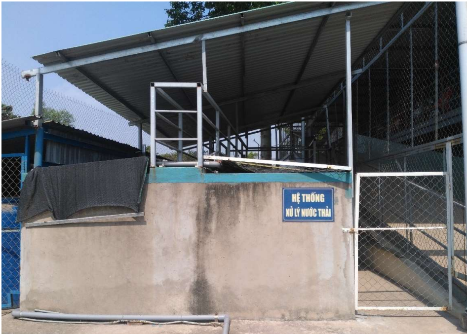
Hình 3.6. Hình ảnh HTXL nước thải tại công ty
