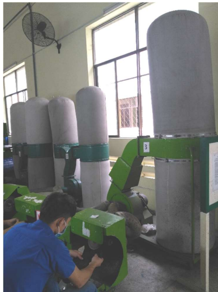
Hình 3.9. Hệ thống túi vải di động xử lý bụi tại máy cán liệu, tạo hạt
