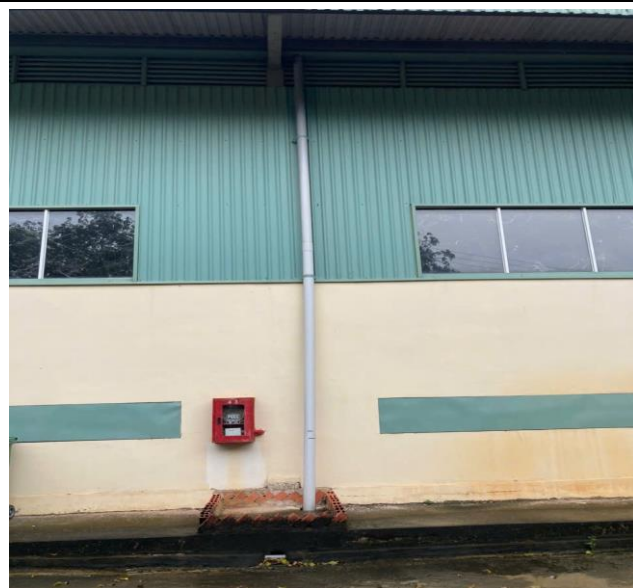
Hệ thống thu gom nước mưa xung quanh nhà xưởng, văn phòng
