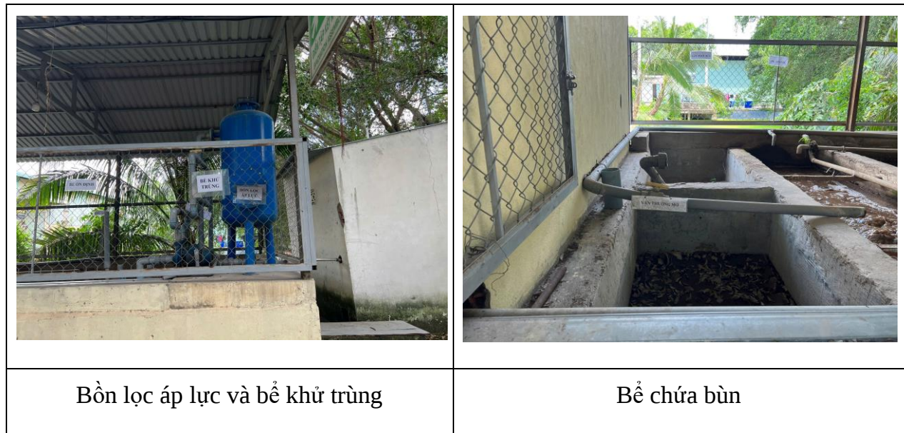
Hình 3. 8. Hệ thống xử lý nước thải, công suất 50 m 3 /ngày.đêm
