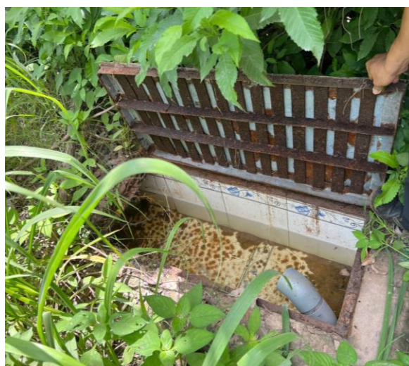
Hình 3. 4. Hố ga đầu nối nước thải sau xử lý của Nhà máy
