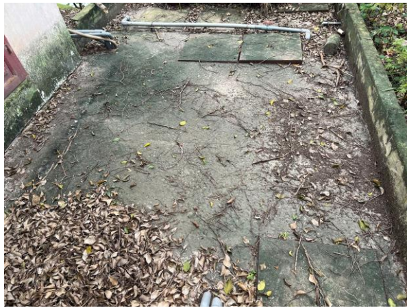
Bể điều hòa
