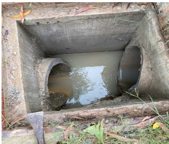
Hố ga đầu nối nước mưa tại 01 điểm trên đường Tân Hiệp 14 tiếp giáp Nhà máy về phía Tây Bắc
