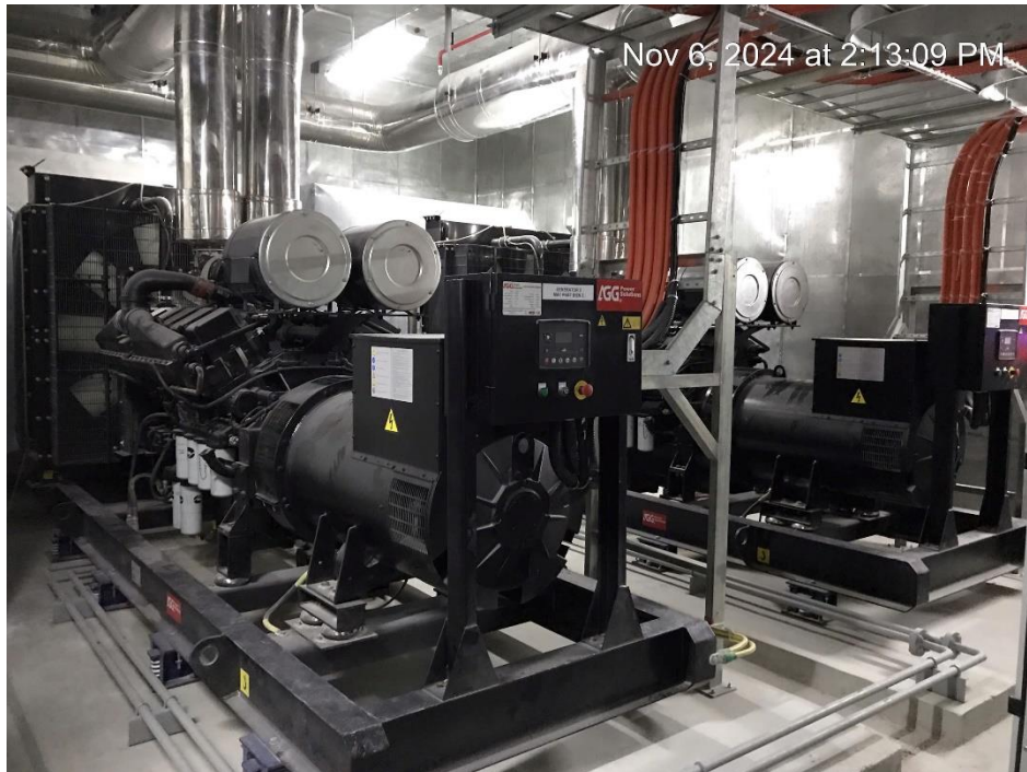
Hình 1. 17: Máy phát điện tại dự án
