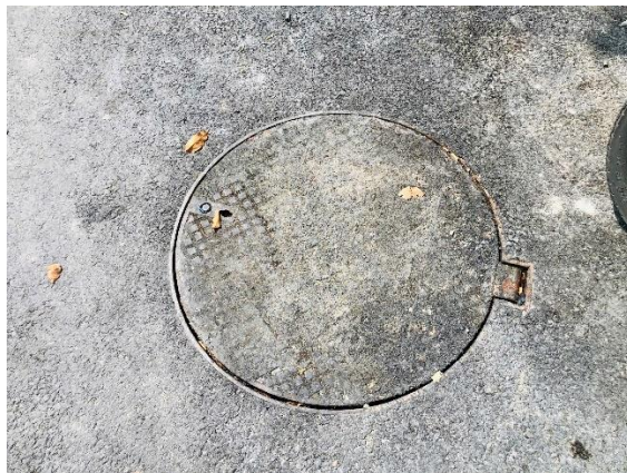
Hố ga đầu nối nước thải trên đường JF1A (đường Bùi Thị Xuân)
