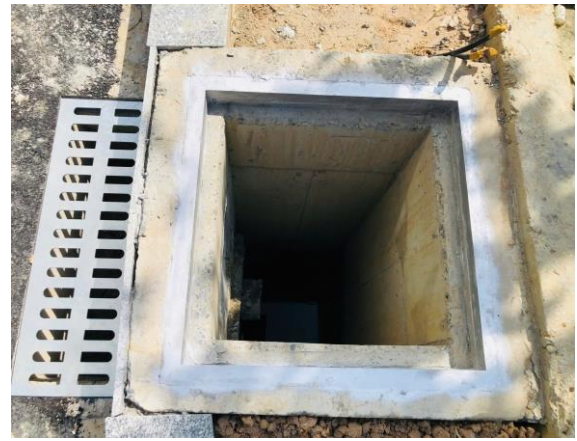
Vị trí đầu nổi nước mưa trên đường JF1A (đường Bùi Thị Xuân)
