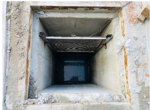
Hố ga đầu nối nước thải trên đường GH1
