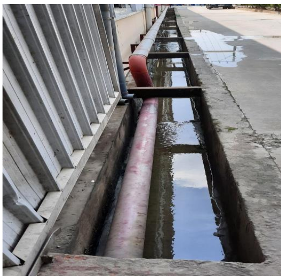
Hình 4. Mương thu nước mưa
