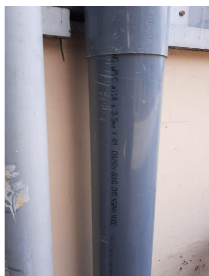
Hình 5. Ống PVC thu gom nước mưa từ mái nhà xưởng
