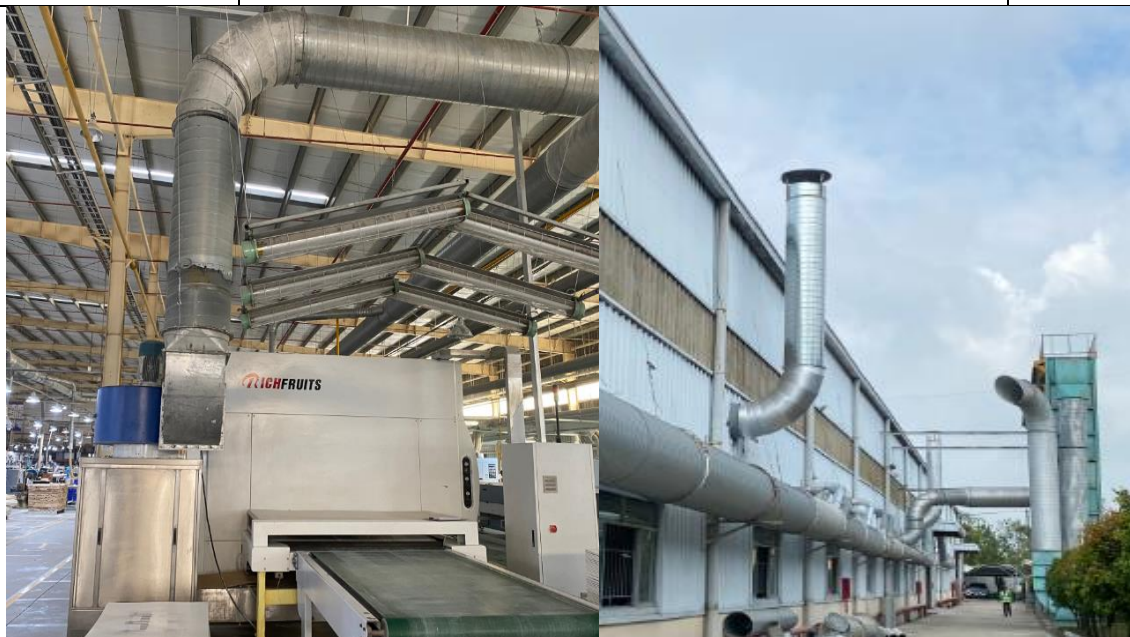
Hình 22. Thiết bị lọc than hoạt tính số 3, 4
