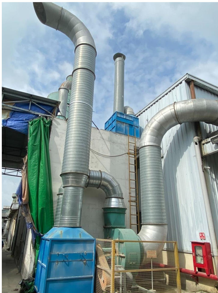
Hình 21. Thiết bị lọc than hoạt tính số 1, 2
