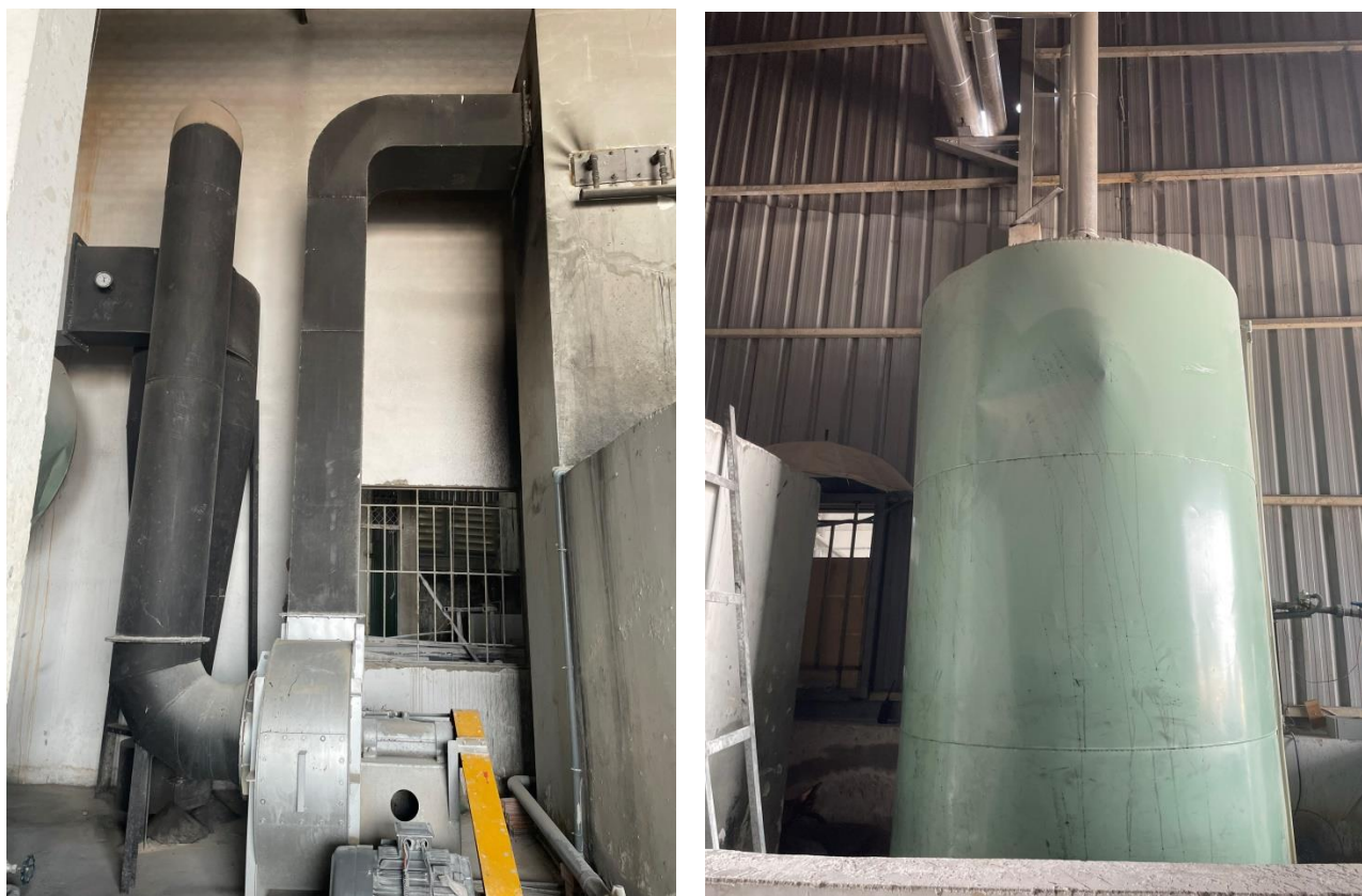
Hình 32. Hệ thống xử lý khí thải lò hơi
