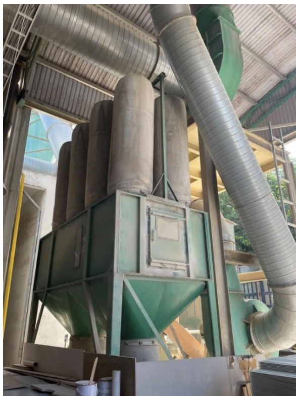
Hình 17. Thiết bị lọc bụi túi vải
