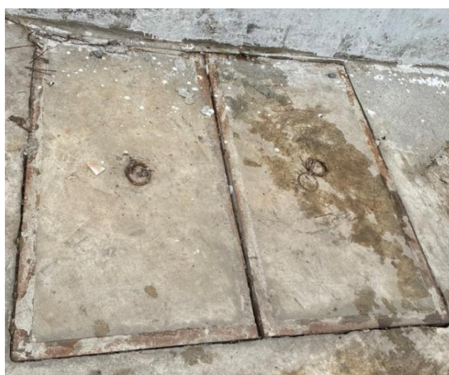
Hình 7. Hố ga đầu nối nước thải với hệ thống thoát nước của khu vực
