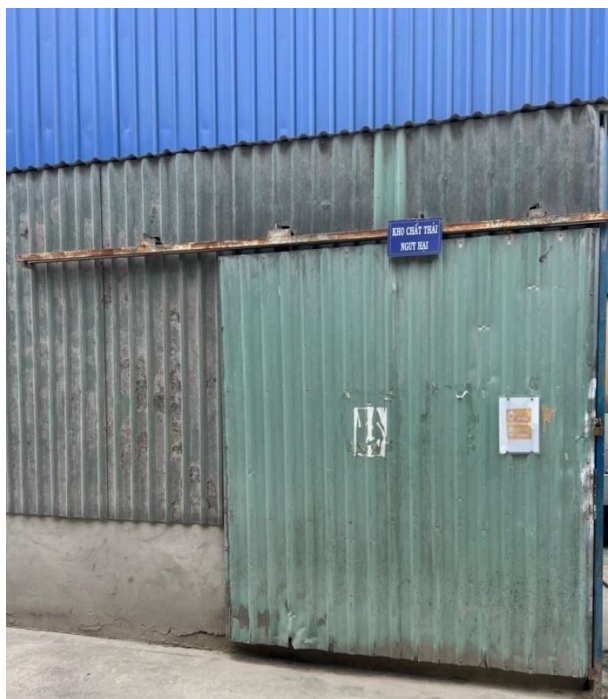
Hình 34. Nhà chứa chất thải nguy hại
