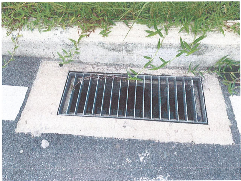
Hình 3.3. Hệ thống thu gom thoát nước mưa tại cơ sở
